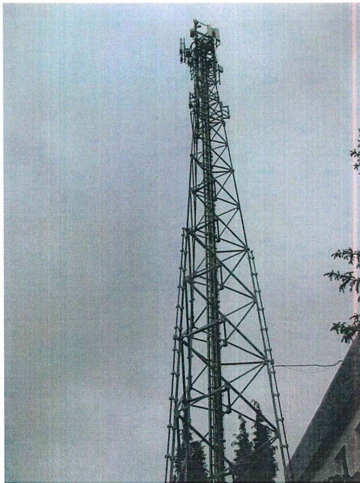
Zal. nr 1: Widok ogólny instalacji radiokomunikacyjnej.
