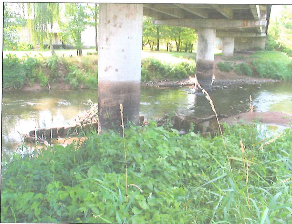
Fot. 40. Przestrzeń pod mostem – przesło nurtowe Nr 3. Zanieczyszczenia i ubytki gruntu w obrębie słupów filara. Spróchniałe ścianki szczelne i konary suchych drzew utrudniają przepływ wody i zatrzymują płynące zanieczyszczenia.
