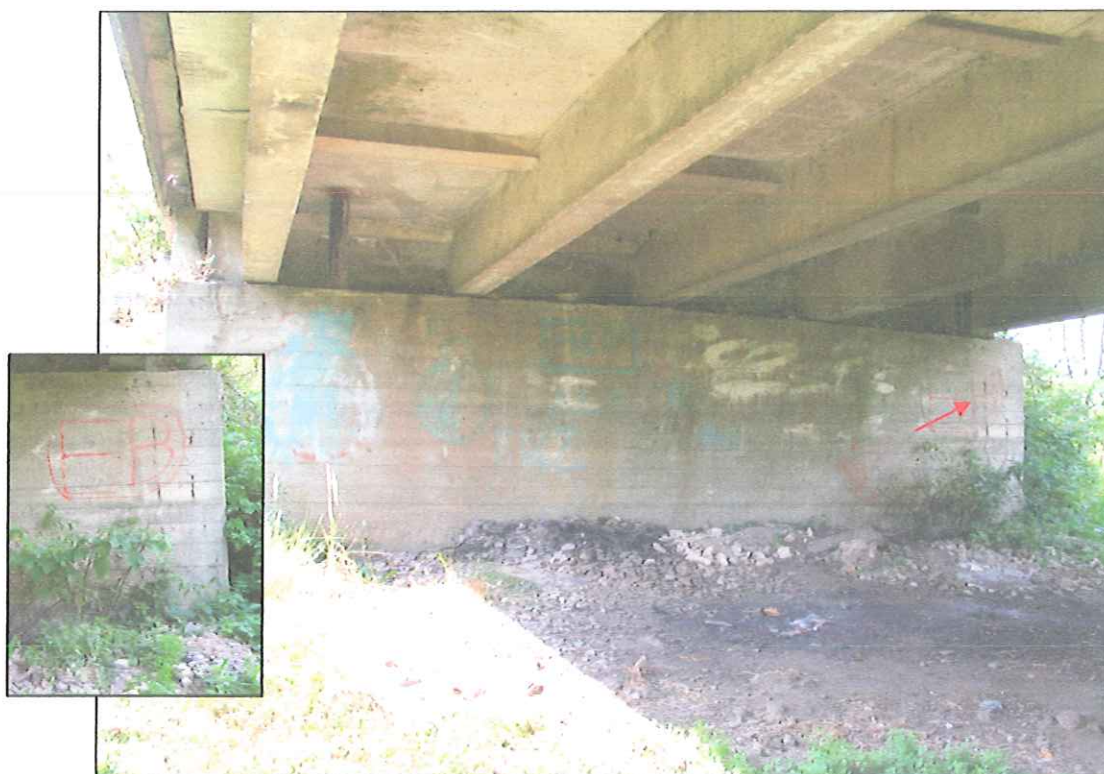
Fot. 31. Korpus przyczółka od strony m. Boria. Zanieczyszczenia w postaci „graffiti”. Ubytki betonu i korozja odsłoniętych prętów zbrojeniowych. Zbyt mała grubość betonowej otuliny zbrojenia w tych miejscach.
