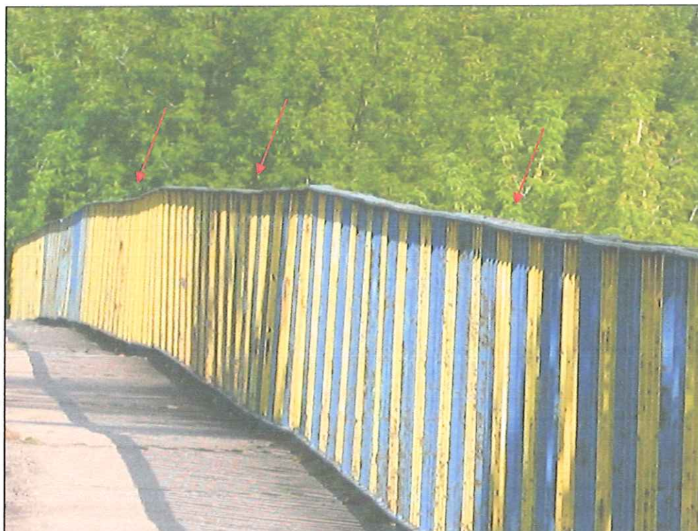
Fot. 16. Balustrada szczepklinkowa od strony górnej wody (GW). Brak prostoliniowości poręczy balustrady szczepklinkowej odwzorowującej ugięcia przęsł. Zanieczyszczenia, ubytki powłoki malarskiej i postępująca korozja wżerowa.
