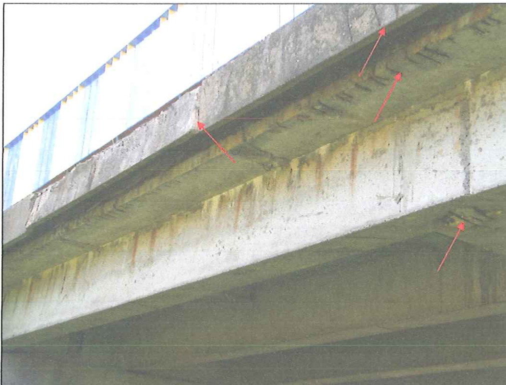
Fot. 17. Prefabrykowana belka gzymsowa po strony dolnej wody (DW) – przęsło Nr 6. Lokalne ubytki betonowej otuliny zbrojenia. Widoczne korodujące pręty zbrojeniowe w wyniku zbyt małej grubości betonowej otuliny zbrojenia. Przemieszczenie gzymsu jednego z segmentów prefabrykowanej kapy chodnikowej. Widoczna korozja prętów na spodzie płyty i poprzecznicy przęsłowej.
