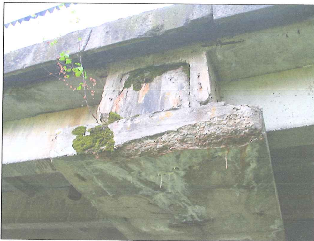
Fot. 39. Widok z boku na oczek podpory Nr 2 od strony dolnej wody (DW). Zanieczyszczenia, wegetacja roślinności (mchu), osady, wykwity wapienne w postaci stalaktytów. Ubytki betonu i korozja odsłoniętych prętów zbrojeniowych. Uszkodzenia świadczą o długotrwałej penetracji wody spływającej z poziomu izolacji.
