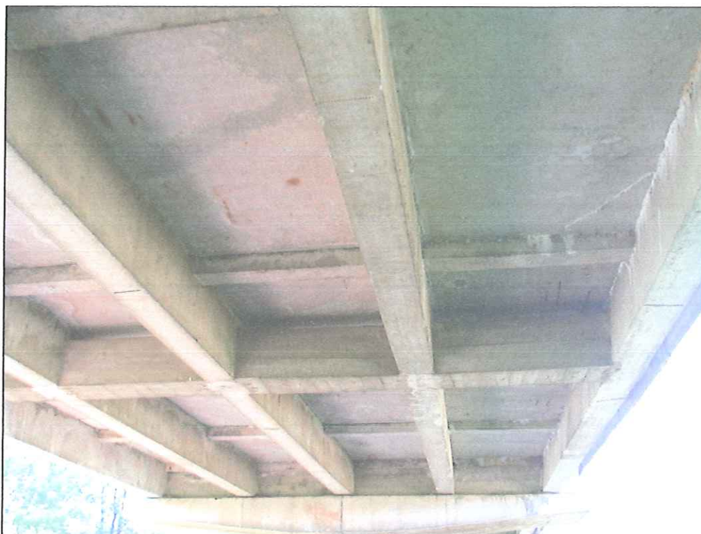
Fot. 24. Spód ustroju nośnego - przęsło Nr 5. Zacieki i wykwyty wapienne świadczące o awaryjnym stanie izolacji przeciwwodnej. Rdzawe wykwyty na spodzie płyty świadczą o korozji zbrojenia w wyniku zbyt małej grubości betonowej otuliny zbrojenia.
