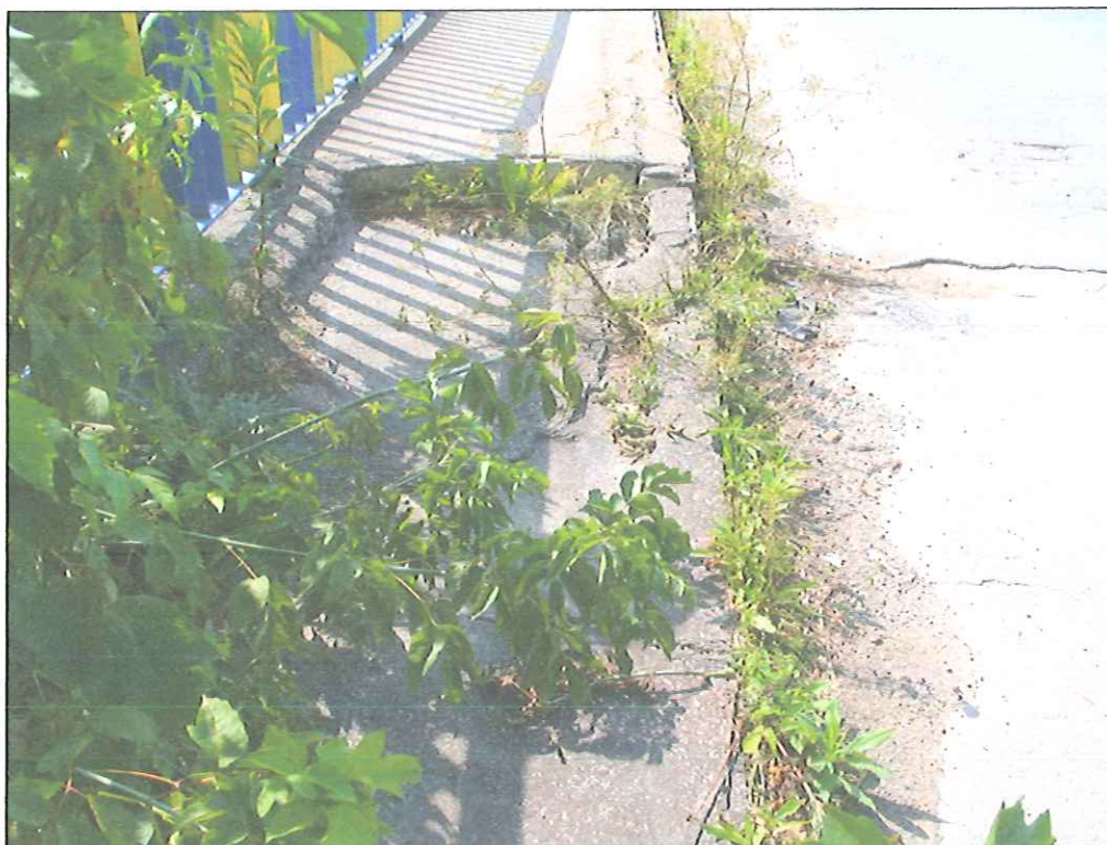
Fot. 13. Chodnik na dojeździe od strony m. Podgórze – górnej (GW). Zaniżenie nawierzchni chodnika w obrębie skrzydełek. Zanieczyszczenia i wegetacja roślinności przy krawężniku.
