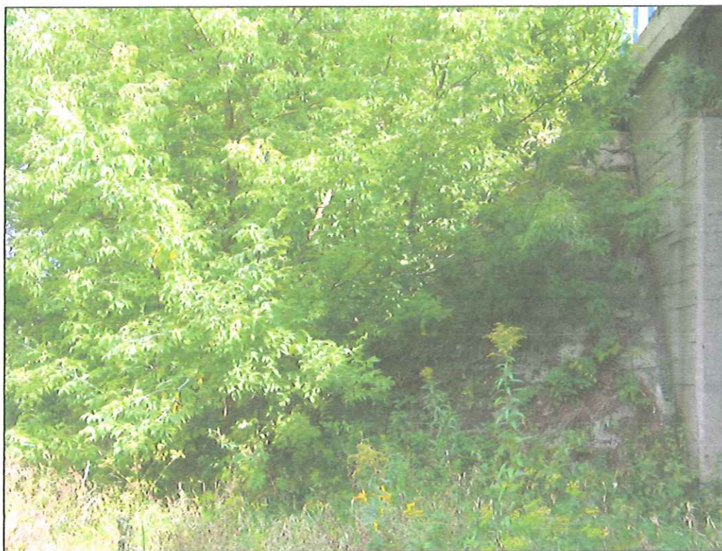
Fot. 6. Stożek nasypu od strony m. Podgórze – dolnej wody (DW). Zanieczyszczenia i zaawansowania wegetacja roślinności. Brak prac porządkowych w ramach bieżącego utrzymania obiektu.
