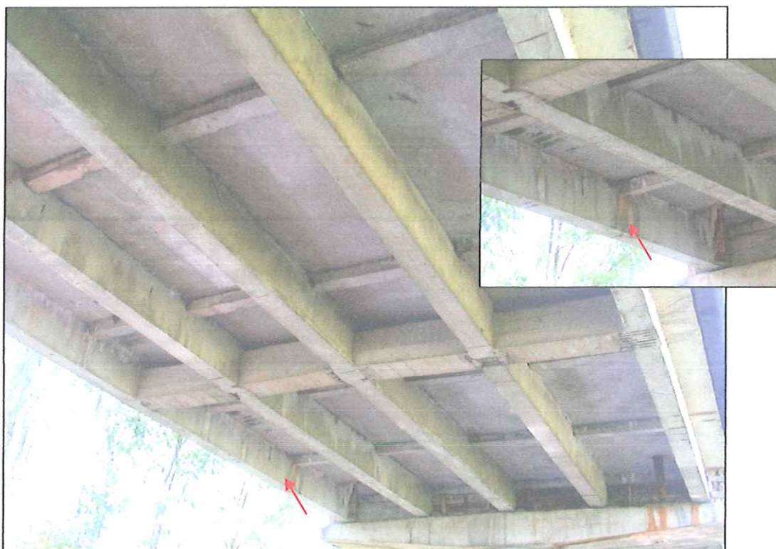
Fot. 26. Spód ustroju nośnego - przęsło Nr 3. Zacieki i wykwyty wapienne świadczące o nieuszczelności na zamkach zespalających prefabrykowane płyty pomostu.
