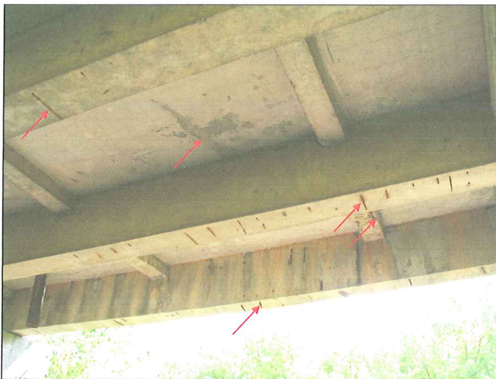
Fot. 22. Widok spodu ustroju nośnego – przęsło Nr 6 od górnej wody (GW). Zanieczyszczenia, osady i wykwyty wapienne na bocznej powierzchni płyty świadczące o przeciekach wody z poziomu izolacji. Spękania siatkowe i złuszczenia betonu na spodzie płyt prefabrykowanych. Widoczna korozja strzemion na spodzie belek typu CZDP świadcząca o braku betonowej otuliny.
