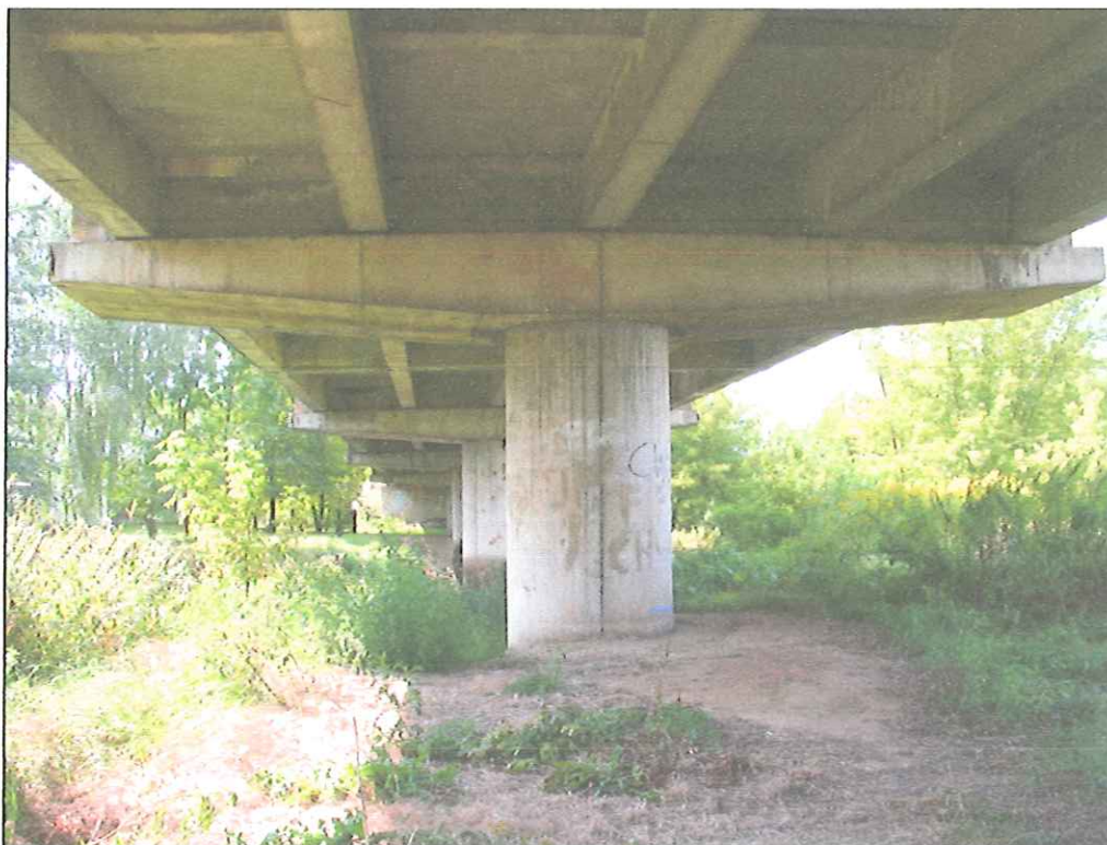
Fot. 35. Widok z przodu na podporę pośrednią Nr 5 od strony m. Podgórze. Zanieczyszczenia, osady, wykwity wapienne. Korozja betonu na końcach odczepu, do których przyczynia się woda spływająca z poziomu izolacji.
