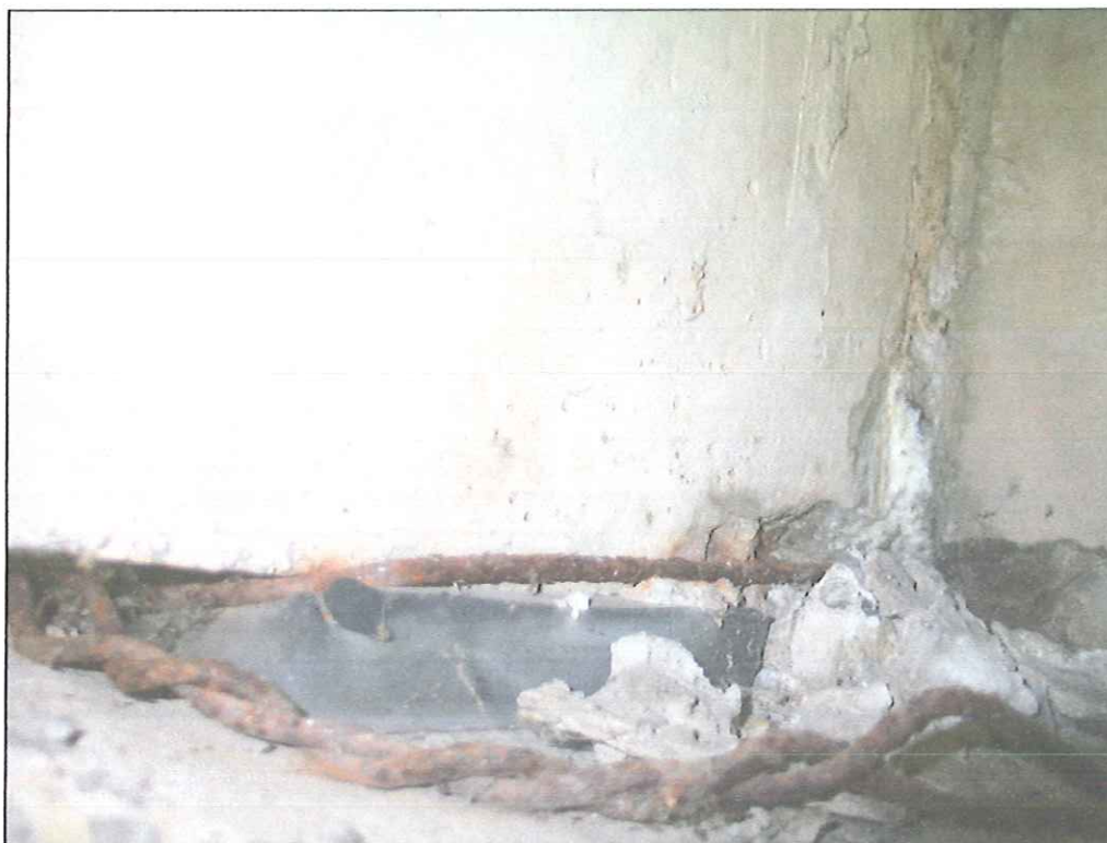
Fot. 27. Łożysko elastomerowe na korpusie przyczółka od strony m. Boria. Widoczne zanieczyszczenia i odkształcenia elastomeru. Nie stwierdzono uszkodzeń ustroju nośnego świadczących o złej pracy łożysk.
