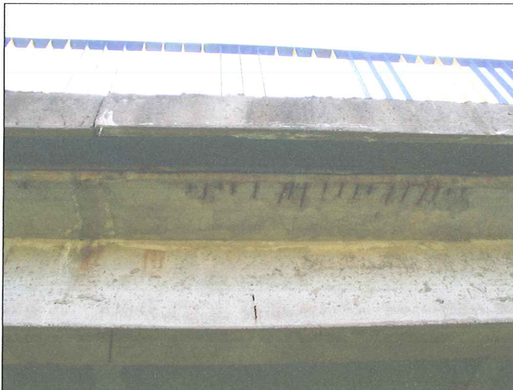
Fot. 23. Widok sposobu odprowadzenia wody z poziomu izolacji – przęsło Nr 6 od strony dolnej wody (DW). Ubytki betonu i korozja zbrojenia.
