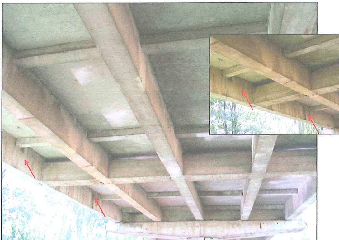
Fot. 25. Spód ustroju nośnego - przęsło Nr 4. Zacieki i wykwyty wapienne świadczące o awaryjnym stanie izolacji przeciwwodnej. Spękania siatkowe i złuszczenia betonu na spodzie płyt prefabrykowanych.
