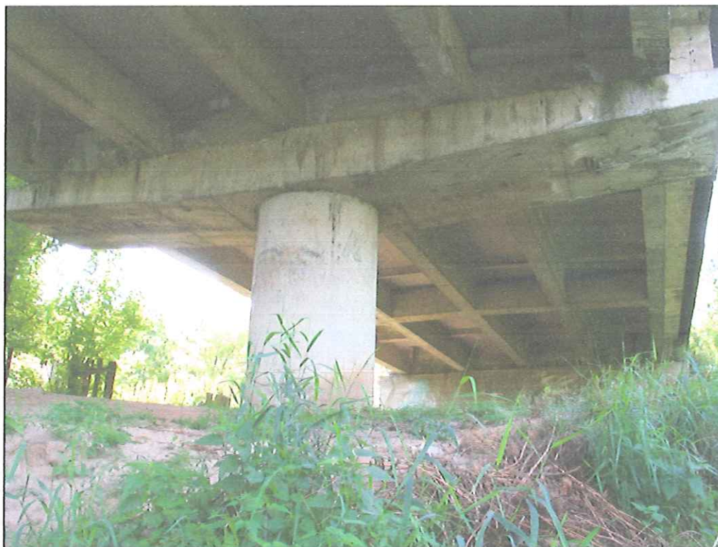
Fot. 38. Widok z przodu na podporę pośrednią Nr 2 od strony m. Podgórze. Zanieczyszczenia, osady, wykwity wapienne w postaci stalaktytów oraz ubytki betonu. Korozja odsłoniętych prętów zbrojeniowych. Przecieki wody przez nieszczelną izolację uszkodzoną w miejscu ucięcia płyty nad podporą.
