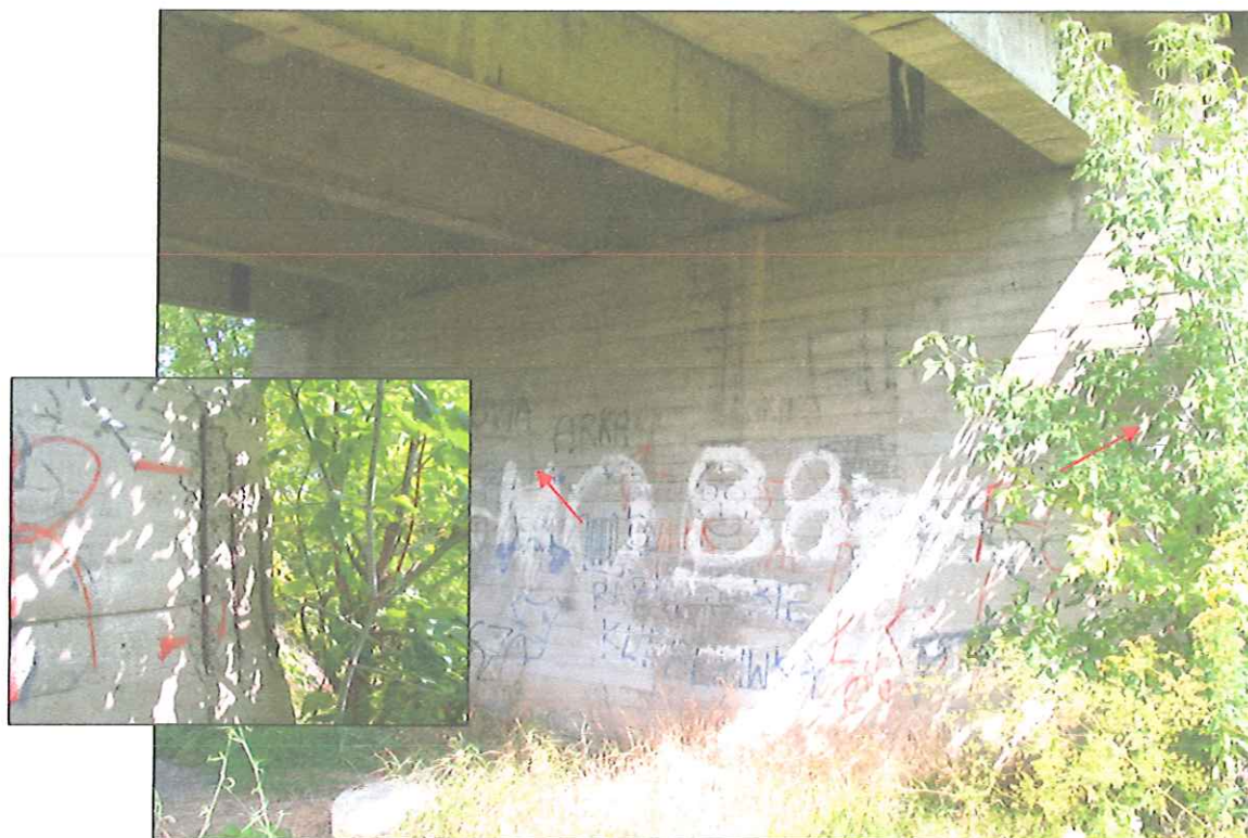
Fot. 29. Korpus przyczółka od strony m. Podgórze. Zanieczyszczenia w postaci „graffiti”, ubytki betonu oraz korozja odsłoniętych prętów zbrojeniowych. Zbyt mała grubość betonowej otuliny zbrojenia w tych miejscach.
