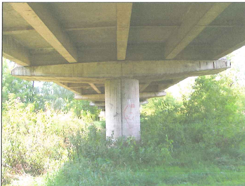
Fot. 32. Widok z przodu na podporę pośrednią – Nr 6 od strony m. Podgórze. Zanieczyszczenia w postaci „graffiti”, osady i wykwyty wapienne, zarysowania i ubytki przypowierzchniowej warstwy betonu. Korozja odsłoniętych prętów zbrojeniowych. Zbyt mała grubość betonowej otuliny zbrojenia.
