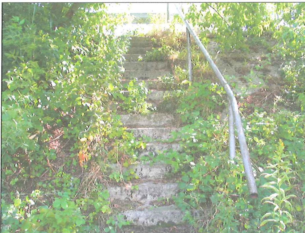
Fot. 7. Schody skarpowe od strony m. Podgórze – dolnej wody (DW). Spękania i ubytki betonu na całej ich powierzchni, zanieczyszczenia i wegetująca roślinność. Brak prac porządkowych w ramach bieżącego utrzymania obiektu. Ubytki powłoki malarskiej i postępująca korozja balustrady rurowej.
