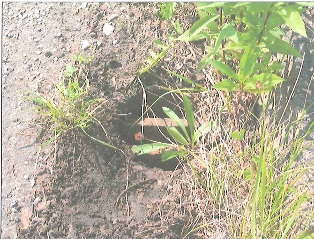
Fot. 19. Wpust żeliwny od strony dolnej wody (DW). Intensywne zanieczyszczenie z wegetacją roślinności powodujące całkowitą niedrożność odwodnienia.
