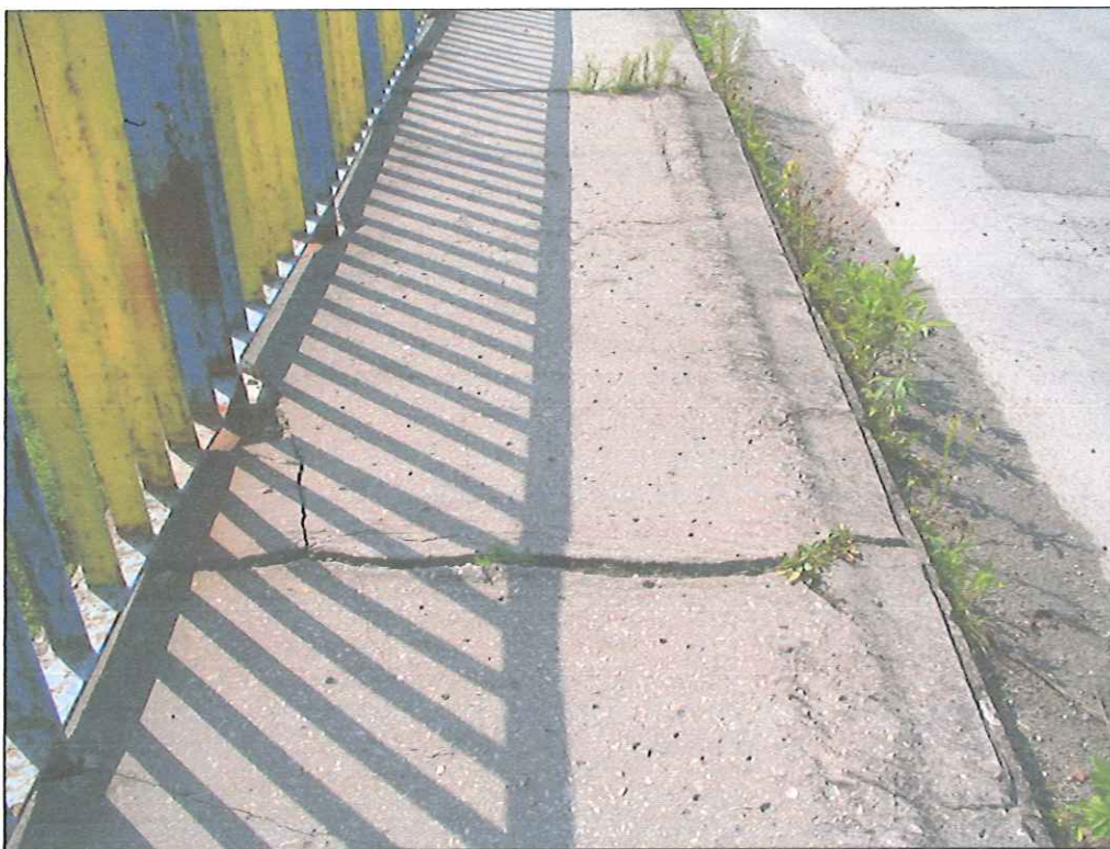
Fot. 14. Nawierzchnia chodnika od strony górnej wody (GW). Widoczne spękania i deformacje nawierzchni chodnika. Wegetacja roślinności w miejscu spękań nawierzchni.
