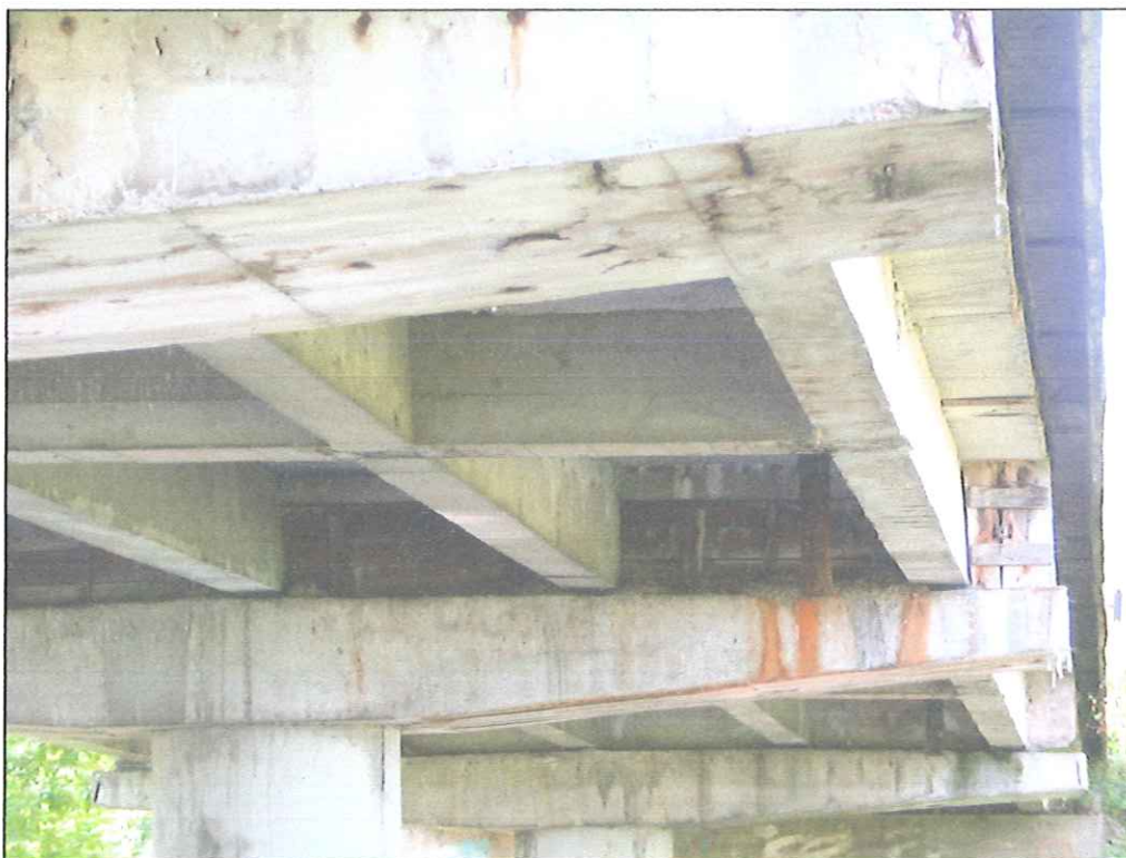
Fot. 37. Widok na oczep z przodu podpory pośredniej Nr 3 od strony m. Podgórze - dolnej wody (DW). Osady, wykwity i wylugowania wapienne, zarysowania i ubytki przypowierzchniowej warstwy betonu. Korozja odsłoniętych prętów zbrojeniowych. Zanieczyszczenia w postaci ptasich „odchodów” na oczepie.
