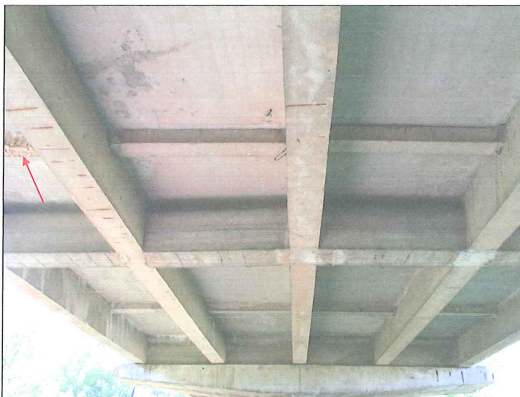
Fot. 20. Spód ustroju nośnego - przęsło Nr 6. Zacieki i wykwyty wapienne świadczące o nieszczelności na zamkach zespajających prefabrykowane płyty pomostu. Korozja strzemion w zamkach zespajających prefabrykowane płyty pomostu oraz na spodzie belek CZDP.
