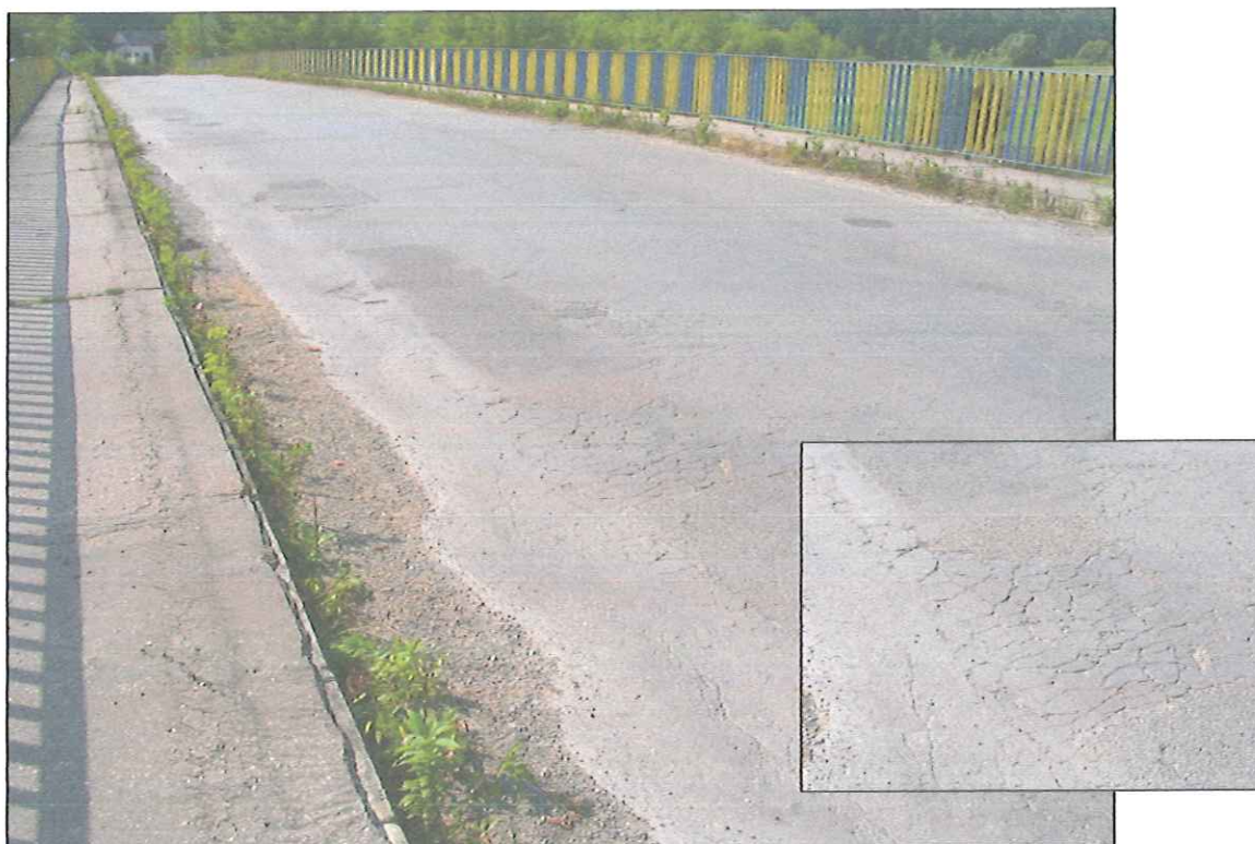
Fot. 10. Nawierzchnia na obiekcie. Zanieczyszczenia nawierzchni jezdni z wegetacją roślinności w obrębie krawężników na całej długości obiektu. Deformacje, pęknięcia siatkowe z ubytkami nawierzchni bitumicznej.
