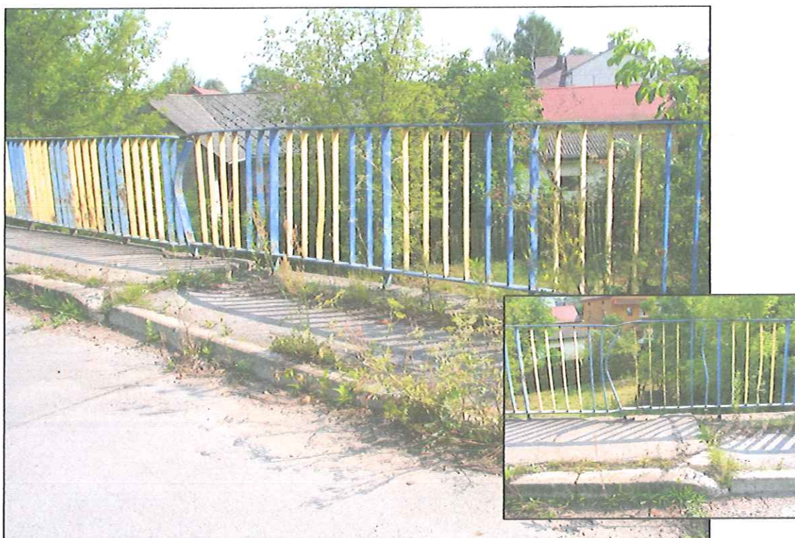
Fot. 15. Balustrada szczepklinkowa od strony górnej wody (GW). Uszkodzenia powłoki malarskiej, przemieszczenia słupków balustrady. Postępująca korozja wżerowa. Deformacje i odkształcenia elementów balustrady w wyniku uderzenia pojazdu.
