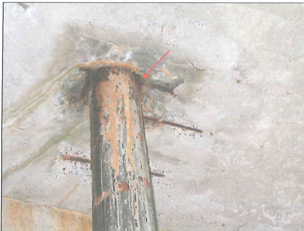
Fot. 18. Rura spustowa od strony górnej wody (GW) - przęsło Nr 1. Ubytki betonowej otuliny i korozja zbrojenia w obrębie krućca wpustu żeliwnego. Zanieczyszczenia i osady na rurze spustowej. Widoczne przecięte zbrojenie płyty pomostu.
