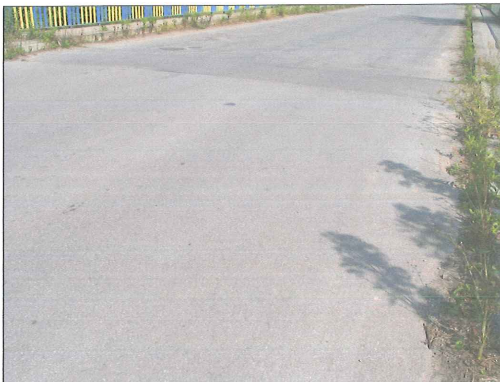
Fot. 9. Nawierzchnia jezdni na dojeździe od strony m. Boria. Zanieczyszczenia nawierzchni jezdni z wegetacją roślinności w obrębie krawężników na całej długości skrzydełek. Lokalne występujące spękania i ubytki nawierzchni.
