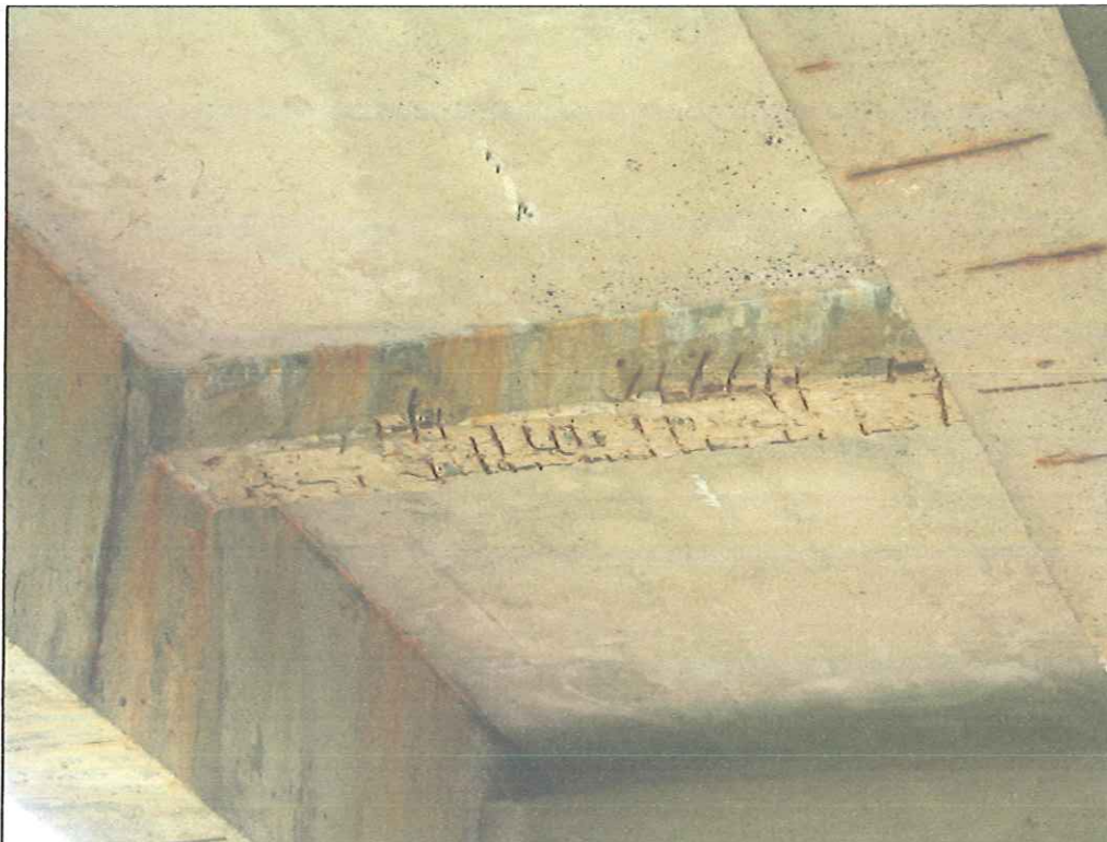
Fot. 21. Widok spodu ustroju nośnego – przęsło Nr 6. Korozja strzemion zamka zespalającego prefabrykowane segmenty płyty pomostu. Brak wymaganej grubości betonowej otuliny zbrojenia. Niedokładności z etapu budowy.
