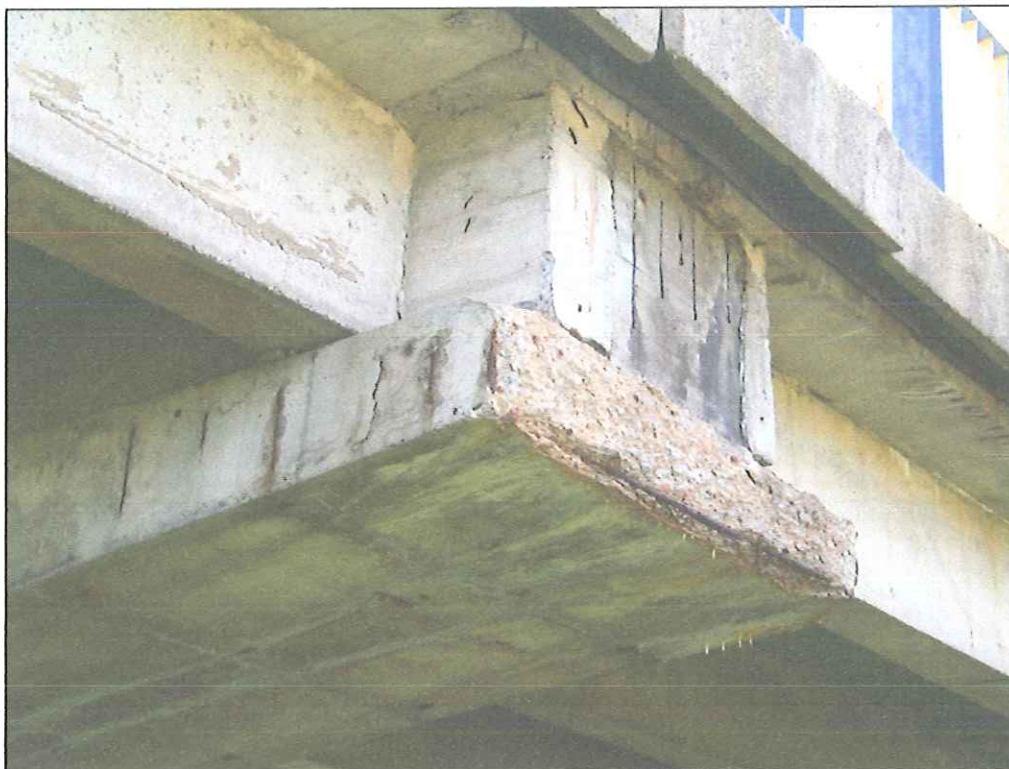
Fot. 33. Widok z boku na podporę pośrednią - Nr 6 od strony dolnej wody (DW). Zanieczyszczenia, zacieki, wykwyty wapienne w postaci stalaktydów i ubytki przypowierzchniowej warstwy betonu. Korozja odsłoniętych prętów zbrojeniowych. Powstałe uszkodzenia świadczą o długotrwałej penetracji wody z poziomu izolacji na płycie.
