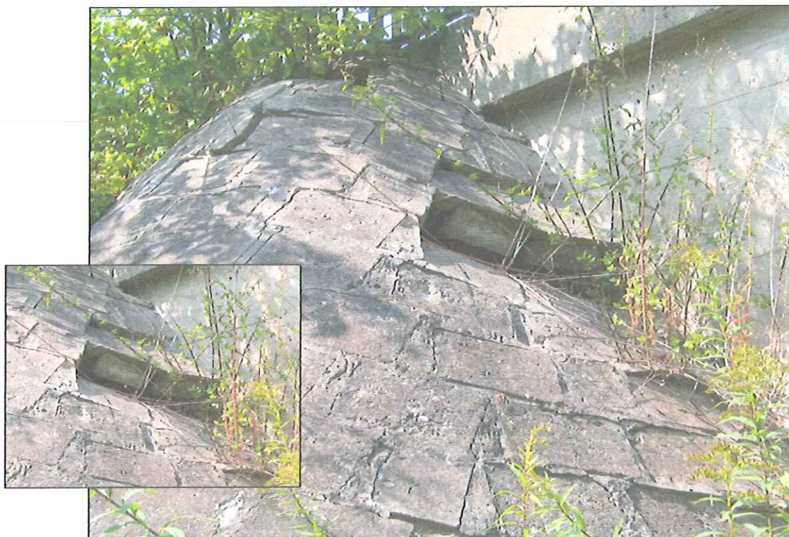
Fot. 5. Stożek nasypu od strony m. Boria – górnej wody (GW). Przemieszczone względem siebie prefabrykowane dyble, ubytki spoin i zaawansowana wegetacja roślinności w szczelinach pomiędzy dyblami.
