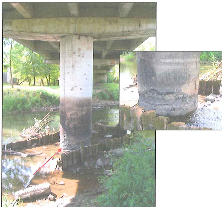
Fot. 36. Widok z przodu na podporę pośrednią Nr 4 od strony m. Podgórze. Ubytki przypowierzchniowej warstwy betonu. Największa intensywność uszkodzeń występuje na wysokości zmiennego poziomu wody.
