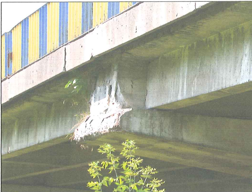
Fot. 34. Widok z boku na podporę pośrednią – Nr 6 od strony górnej wody (GW). Zanieczyszczenia, bujna roślinność. Ubytki betonu i korozja odsłoniętych prętów zbrojeniowych. Występujące uszkodzenia świadczą o wieloletnim procesie penetracji wody z poziomu izolacji. Braku prowadzenia robót w ramach bieżącego utrzymania obiektu.
