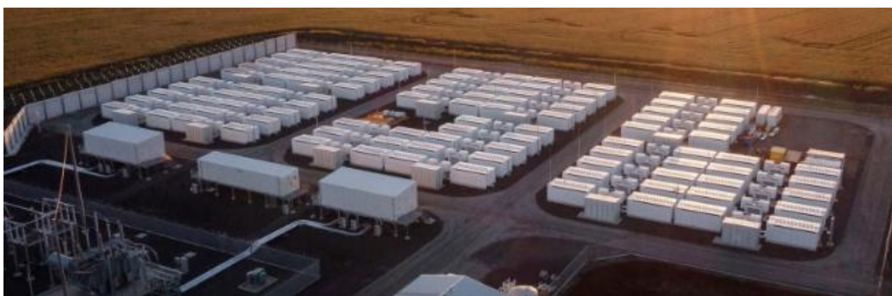
Ryc. 12. Przykład zrealizowanego zespołu magazynów energii (producent Tesla), Australia stan Victoria, system o mocy 350 MW 8
