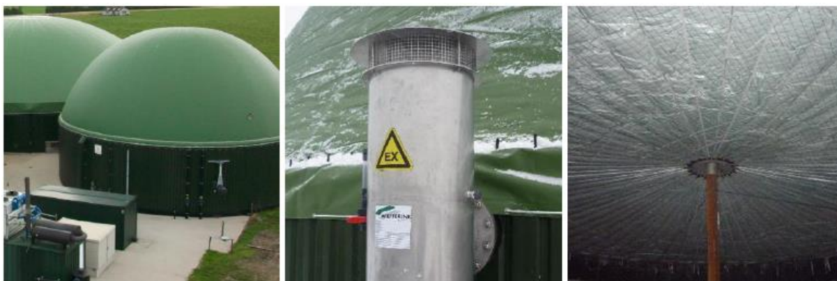
Rys. 3g. Zbiornik biogazu w postaci pokrycia dachowego tzw. membrany (rysunek z lewej). zawór bezpieczeństwa nadciśnienia gazu w zbiorniku (rysunek w środku); membrana z konstrukcją podtrzymującą wewnątrz zbiorniku (rysunek z prawej).
