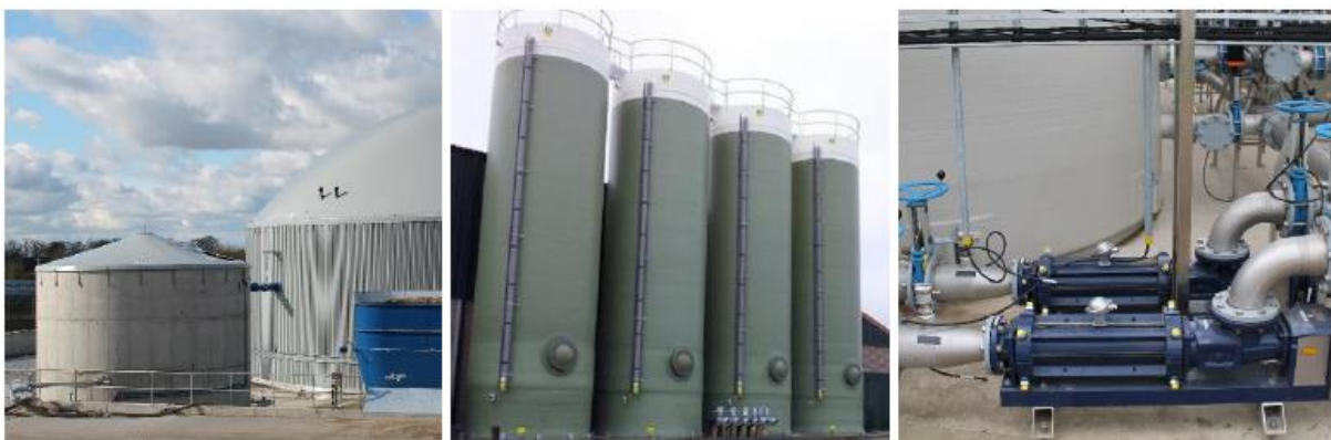
Rys. 3c. Zbiornik na płynne substraty żelbetowy ten mniejszy (rysunek z lewej); zbiorniki magazynowe z tworzywa sztucznego na inne płynne substraty z króćcami przyłączenia na pojazdy dowożące substraty płynne (rysunek środkowy); pompy (rysunek z prawej).
