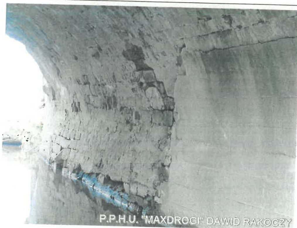
Zdj. 6 Ubytki materiału.
