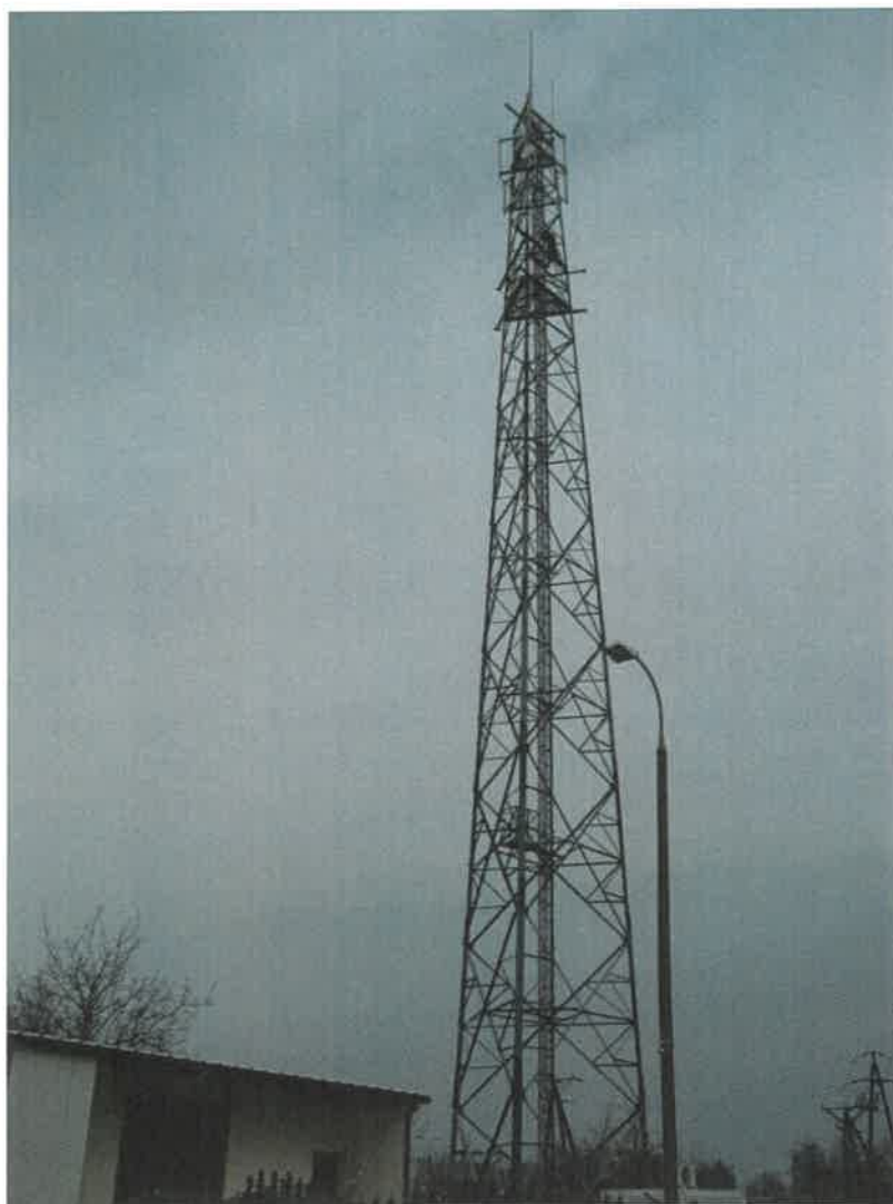
Załącznik nr 1: Widok ogólny instalacji radiokomunikacyjnej.
