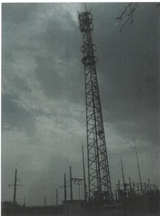
Zał. nr 1: Widok ogólny instalacji radiokomunikacyjnej.
