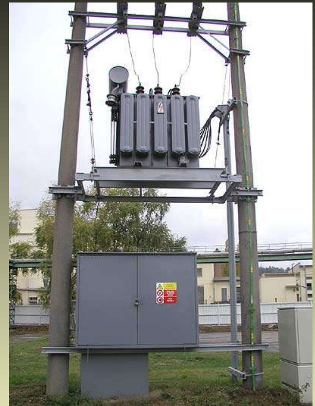
Transformator uliczny przetwarzający napięcie z 15kV do 0,4 kV czyli 250 V.
