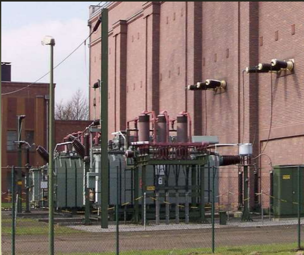
Stacja transformatorowa (TRAFO) z transformatorem wysokiego napięcia.
