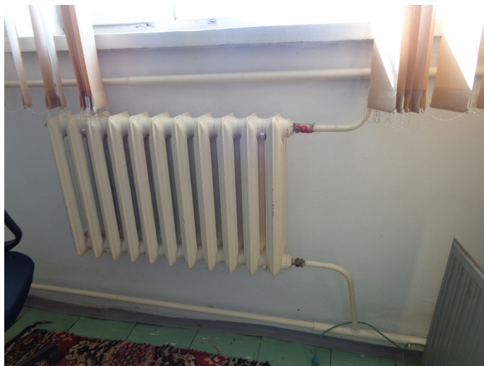
Grzejnik do przeniesienia na sąsiednią ścianę
