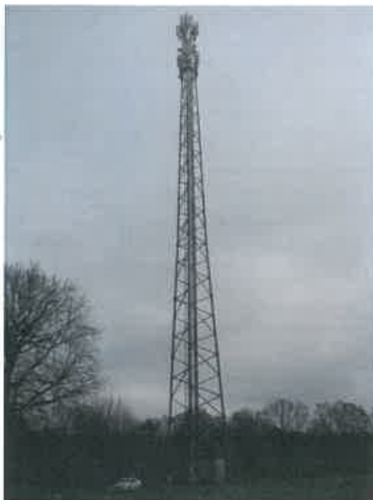
Zof. nr 1: Widok ogólny instalacji radiokomunikacyjnej.
