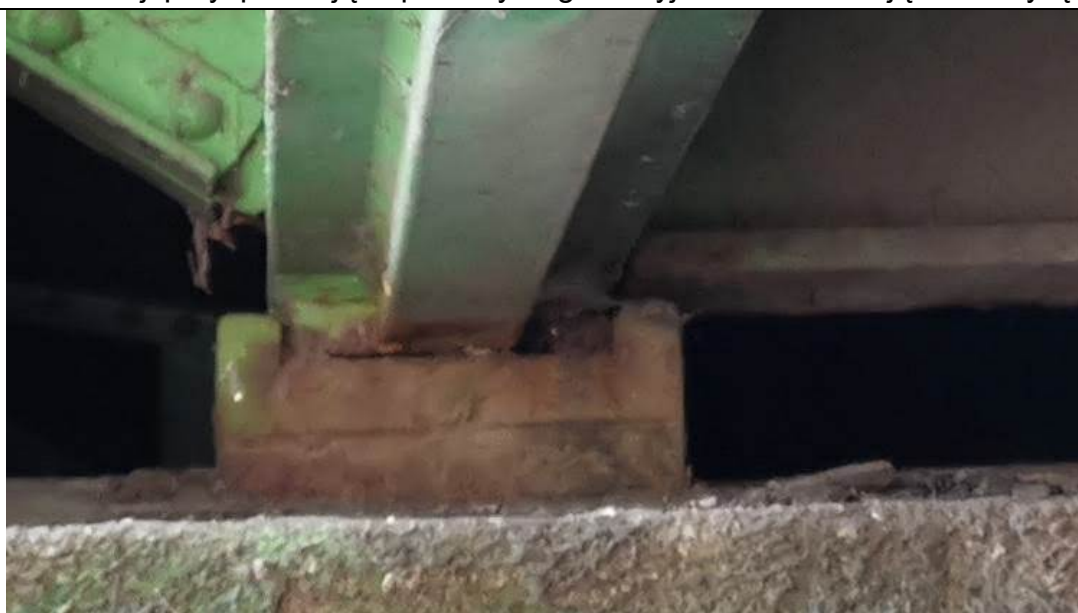
Fot.20. Widok na jedno z łożysko. Widoczne zanieczyszczenia oraz lokalna, niewielka korozja stali. Uszkodzenia dla pozostałych łożysk są analogiczne.
