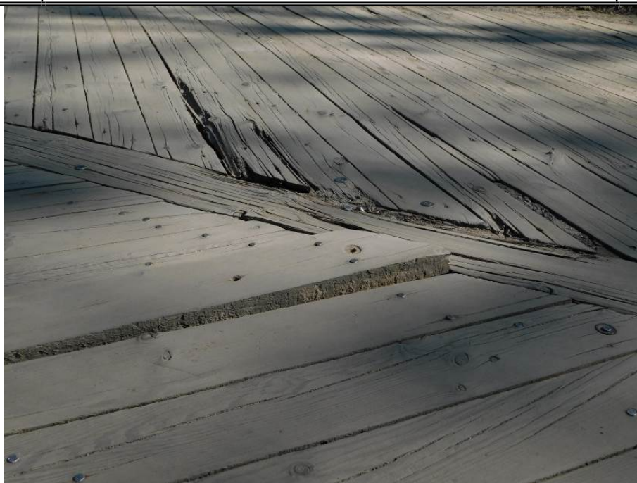
Fot.11. Fragment nawierzchni jezdni. Widoczne zmurszenie dyliny drewnianej oraz uszkodzenia łączników, luźna dylina drewniana.
