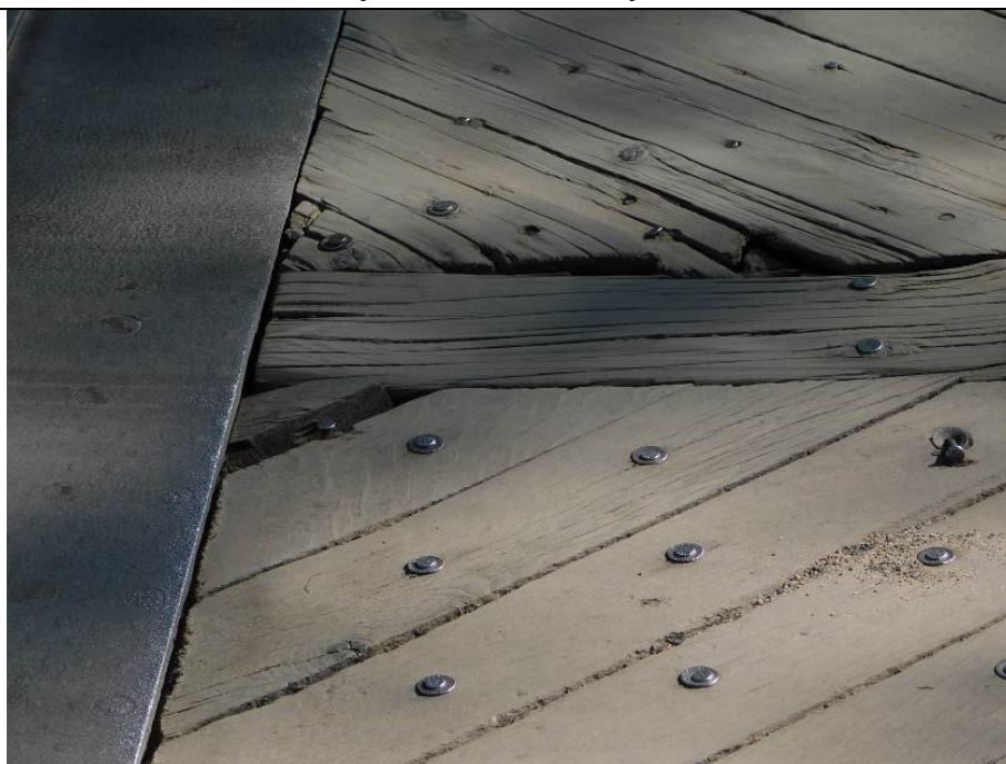
Fot.12. Fragment nawierzchni jezdni. Widoczne zmurszenie dyliny drewnianej, ubytki materiałów.
