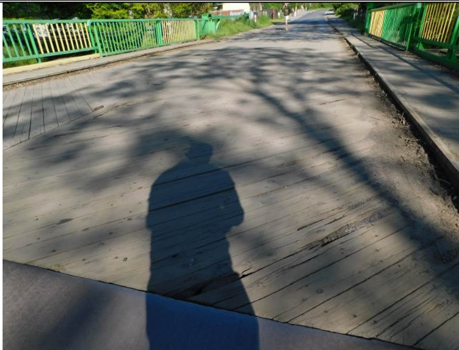
Fot.9. Widok ogólny na pomost. Przykładowe uszkodzenia pokazano na fotografiach poniżej. Stwierdzono klawiszowanie nawierzchni podczas przejazdu pojazdów po obiekcie. Podkład górny jest w stanie przedawaryjnym; widoczne lokalne ubytki materiału, korozja biologiczna drewna, uszkodzenia łączników mocujących podkład górny do dolnego, murszenie drewna. Widoczne zanieczyszczenia przy krawężnikach. Uszkodzenia dyliny drewnianej spowodowane procesami degradacyjnymi materiału.
