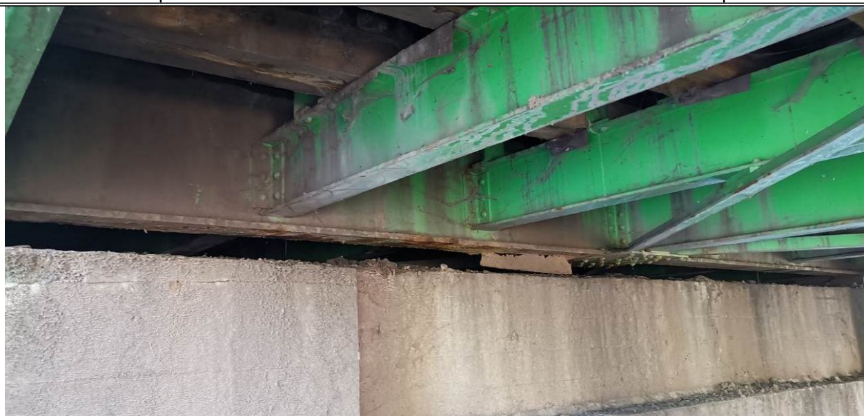
Fot.19. Fragment przęsła. Przęsło nurtowe. Widoczne zanieczyszczenia na powierzchni konstrukcji przyspieszające procesy degradacyjne oraz obniżające estetykę.
