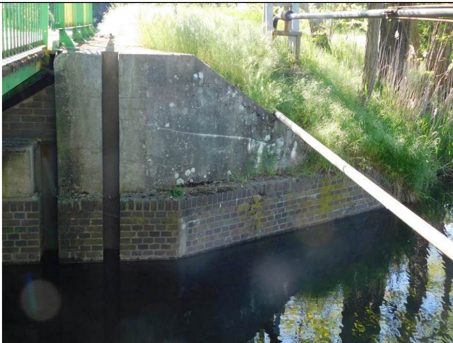
Fot.28. Skrzydło północne filara. Widoczna rysa z wykwittem, vegetacja roślin na powierzchni, zanieczyszczenia.
