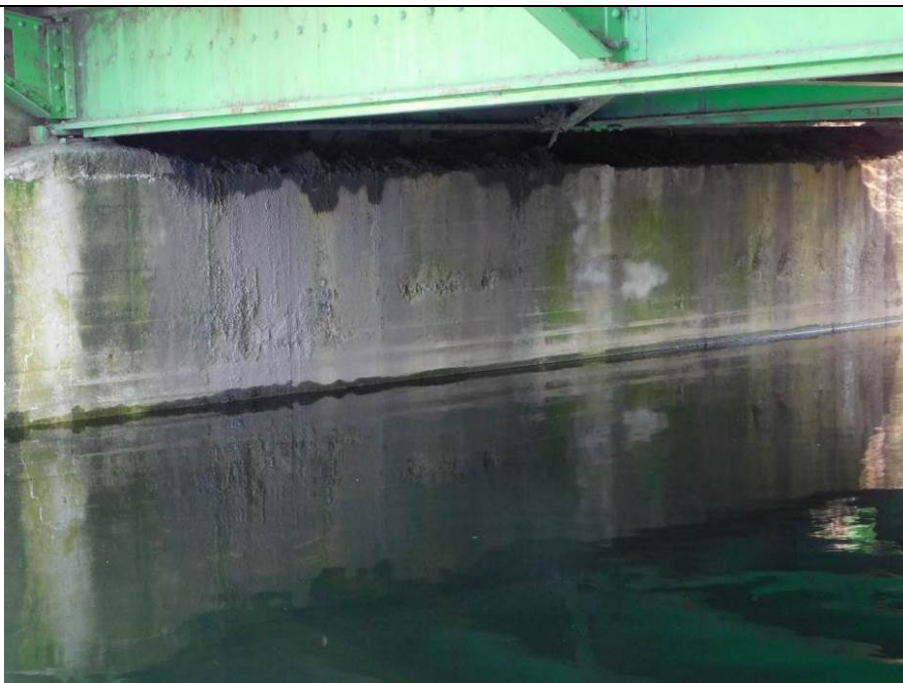
Fot.24. Przyczółek od strony w. Łąkie. Widoczne wykwyty w dolnej części podpory świadczą o lokalnie uszkodzonej izolacji. Wegetacja mikroorganizmów może przyspieszać procesy degradacyjne materiałów konstrukcji. Nisza podłożyskowa jest zanieczyszczona. Widoczne nieliczne zarysowania. Powierzchnia przyczółka jest zanieczyszczona. Widoczne zacieki i wykwyty w górnej części świadczą o nieszczelności w obrębie przykrycia szczeliny dylatacyjnej.
