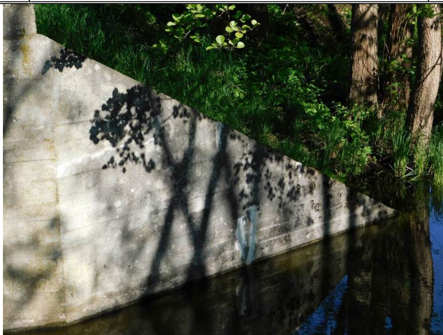
Fot.25. Przyczółek od strony w. Łąkie. Skrzydło południowe. Widoczne zarysowanie wraz z wykwitami. Powierzchnia jest omszona oraz zanieczyszczona.
