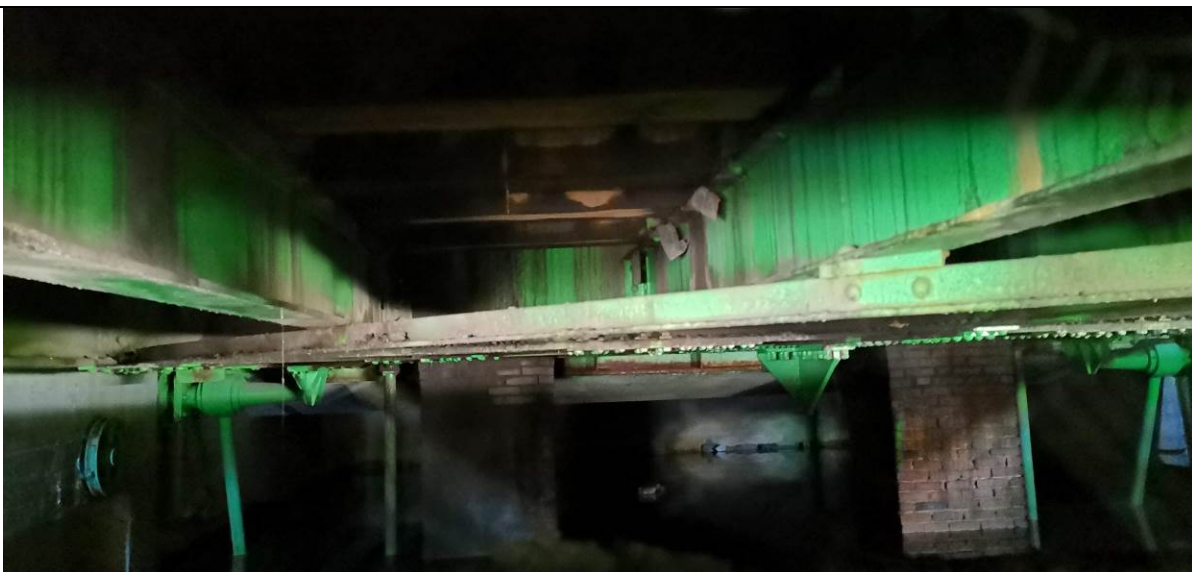
Fot.8. Widok na dolną powierzchnię ustroju nośnego, przęsło nad komorą. Na powierzchni konstrukcji widoczne zanieczyszczenia, lokalne, miejscowe, niewielkie uszkodzenia zabezpieczenia antykorozyjnego wraz z towarzyszącą korozją stali.
