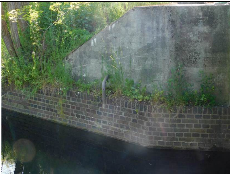
Fot.26. Skrzydło południowe filara. Na powierzchni widoczna wegetacja roślin przyspieszająca procesy destrukcji materiałów konstrukcji. Stwierdzono nieliczne wykwyty oraz zarysowania i ubytki materiałów.
