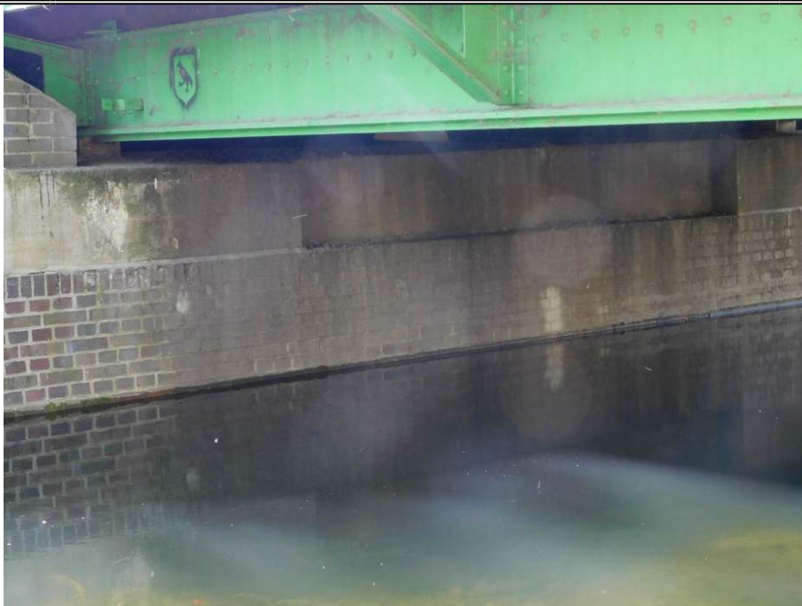
Fot.27. Widok ogólny na filar, od strony przęsła nurtowego. Podpora jest zanieczyszczona, widoczna vegetacja roślin oraz nieliczne wykwyty.
