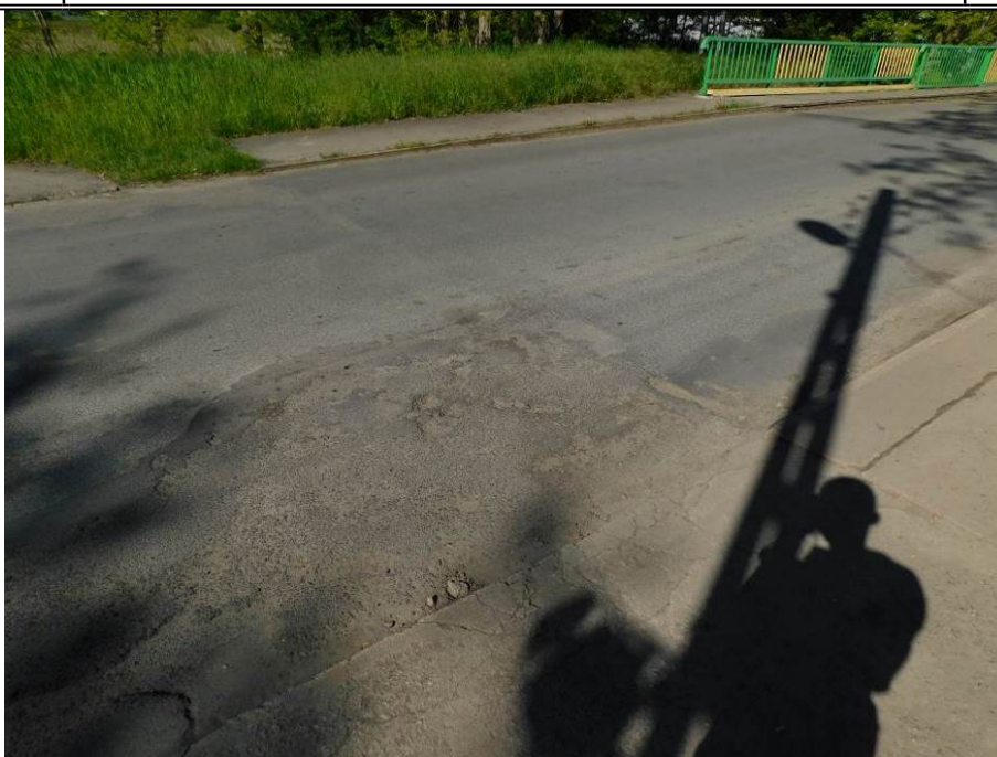
Fot.21. Dojazd do obiektu od strony Niesulic. Widoczne ubytki materiału, nierówności w nawierzchni drogi.
