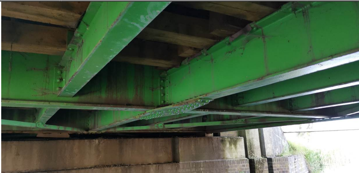
Fot.7. Widok na dolną powierzchnię ustroju nośnego, przęsło nurtowe – nad kanałem Ołobickim. Na powierzchni konstrukcji widoczne zanieczyszczenia, lokalne, miejscowe, niewielkie uszkodzenia zabezpieczenia antykorozyjnego wraz z towarzyszącą korozją stali.
