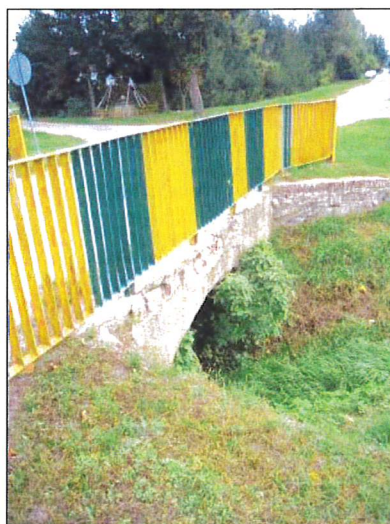
fol. 6. Widok skośnych skrzydeł ceglano – kamiennych odpowiednio od górnej i dolnej wody. Przyzwoity stan techniczny skarp gruntowych. Korodujące balustrady – głównie na styku szczeblin z przeciagiem dolnym! Ubytki obrzutki cementowej w obu nadłuczach,
