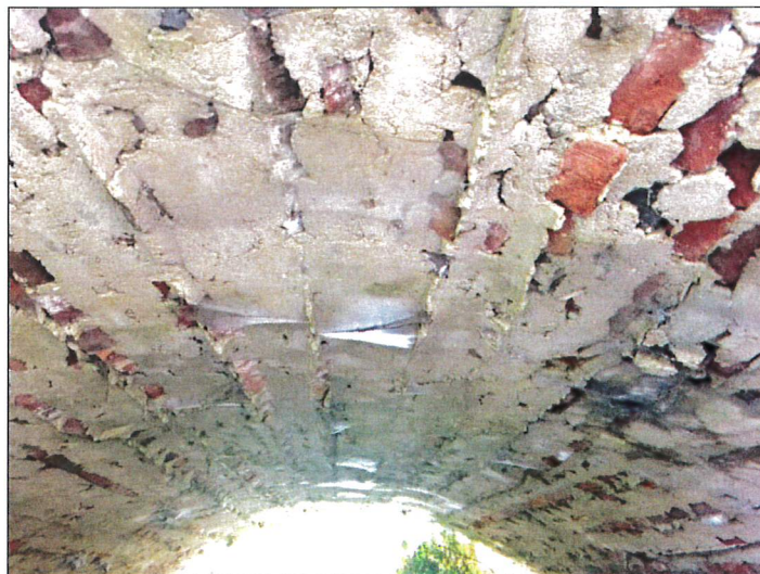
fol. 4. Widok ogólny bardzo przeciętnego stanu technicznego sklepienia ceglanego „w kluczu”. Ubytki spoinowania. Degradacja cegieł.
