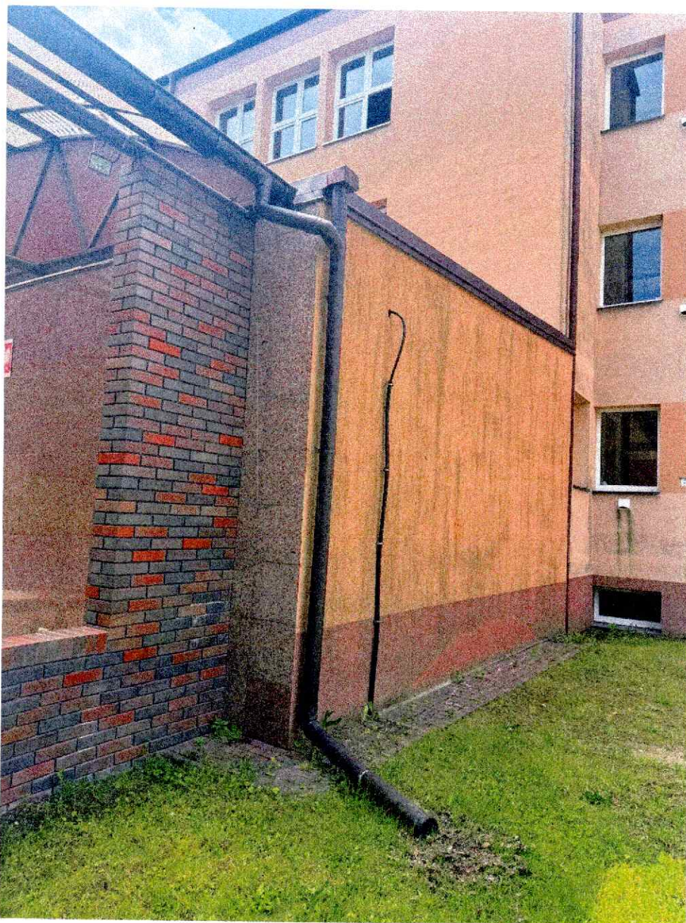
Fot. 4. Widoczne zabrudzenia elewacji
