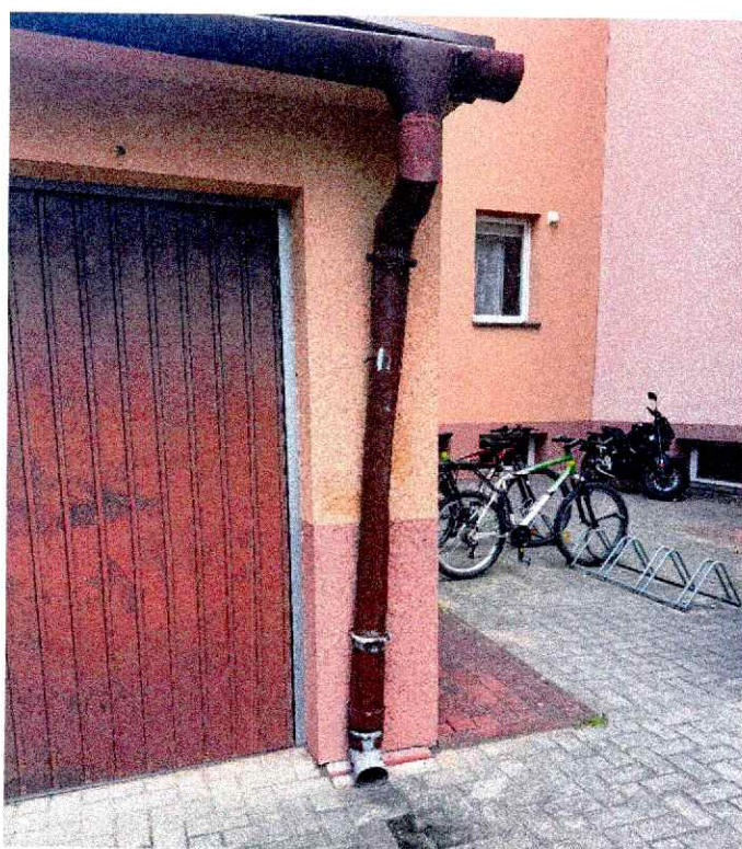
Fot. 13. Widok rury spustowej na południowej widoczna korozja
