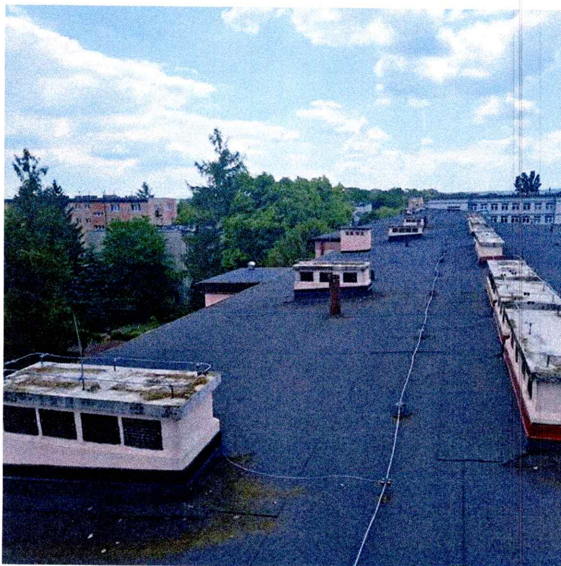
Fot. 5. Dach nad głównym budynkiem szkoły – widoczne spękania i wykwyty przy kolnierzach kominowych
