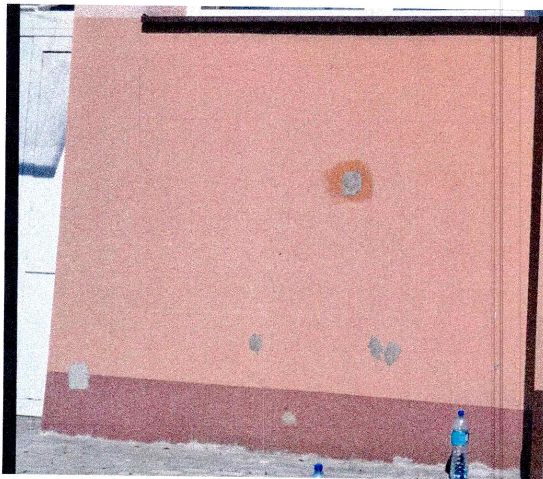
Fot. 3. Ubytki tynków w elewacji budynku
