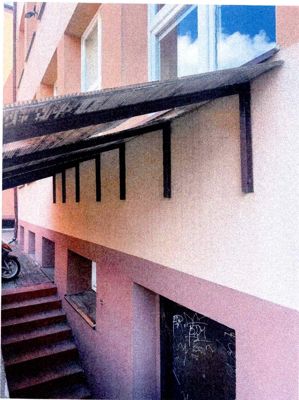
Fot. 10. Widok na zadaszenie nad wejściem do piwnicy- uszkodzone pokrycie
