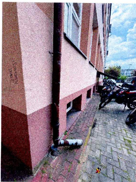
Fot. 12. Widok rury spustowej na elewacji zachodniej – widoczna korozja
