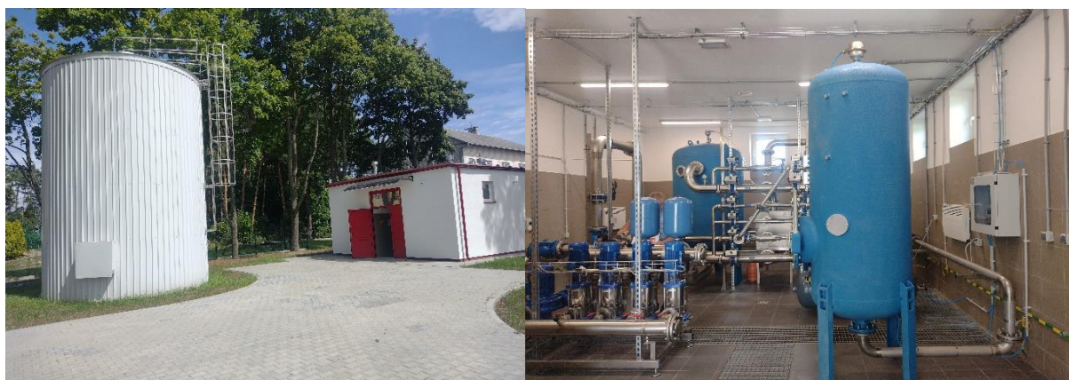
Fotografia 1: Stacja Uzdatniania Wody w miejscowości Krusze (opracowanie własne)
