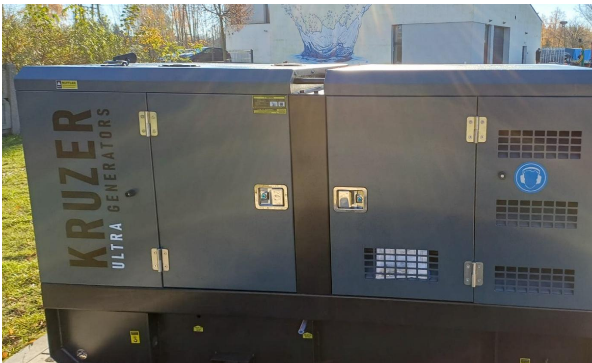
Fot. Agregat prądowórczy. Źródło: archiwum UG Dobroń.
