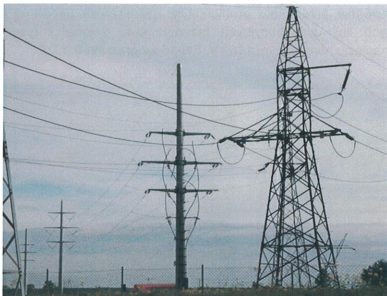
Fot. 3. Linie dystrybucyjne 110 kV (przykłady słupów)
