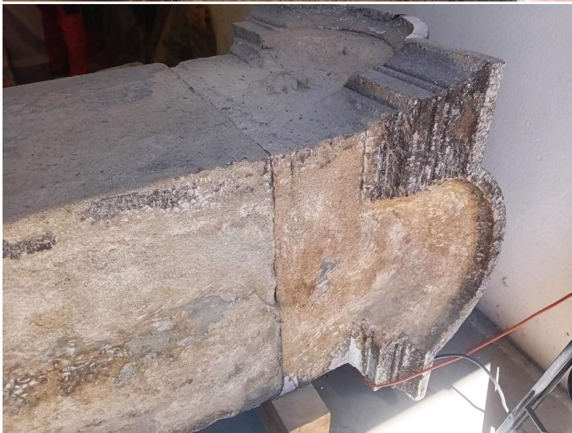
Fot. nr 32-33. Ujęcie na górne element cokołu – dobrze widoczny stan zachowania kamienia w trakcie oczyszczenia z powłok malarskich i szlicht cementowych, wyraźna erozja lica substancji kamienia połączona z dezintegracją granularną. Fot. G. Mienkiewicz, czerwiec 2024 r.
