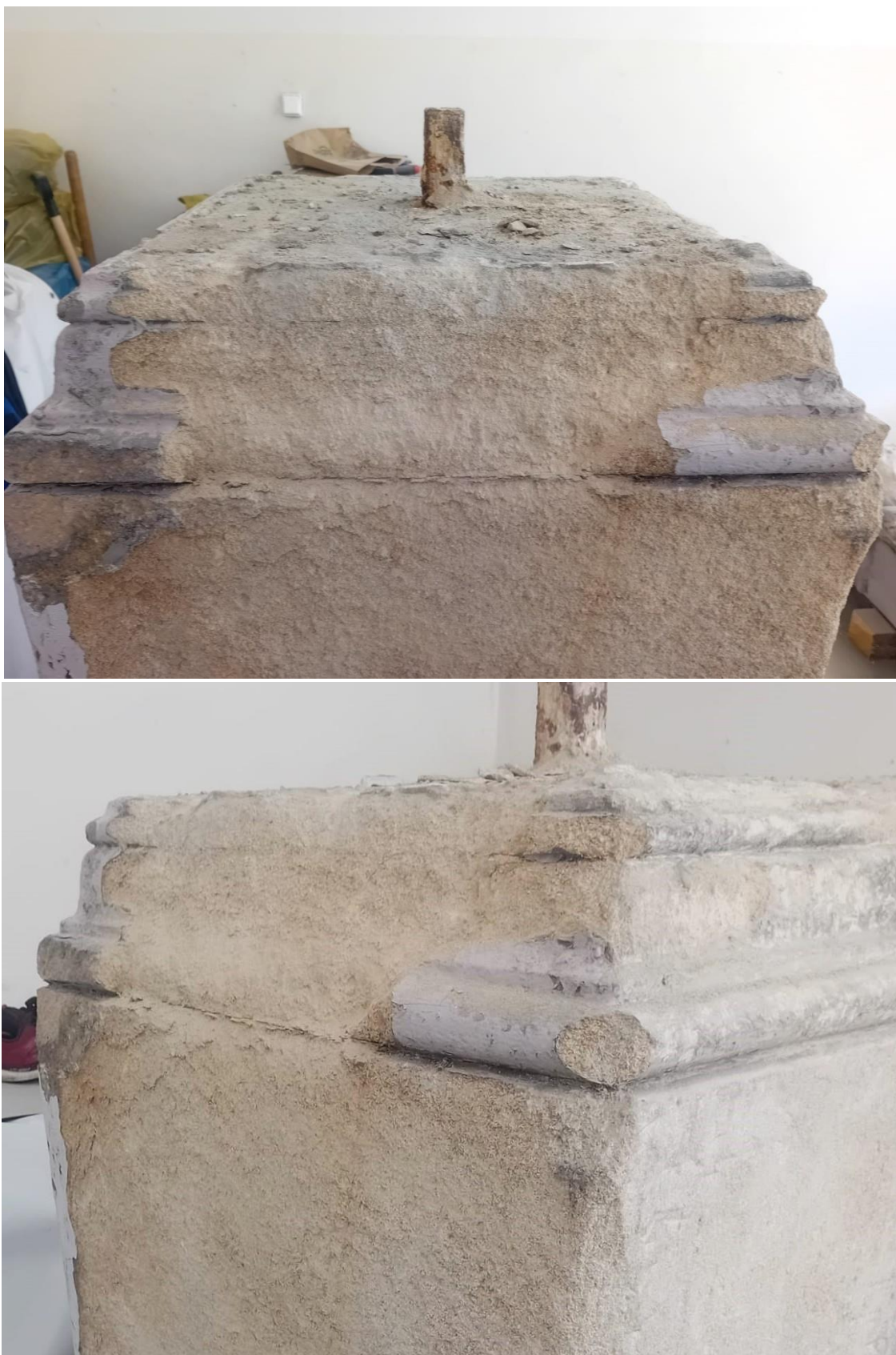
Fot. nr 34-35. Ujęcie na dolne element cokółu – dobrze widoczny stan zachowania kamienia w trakcie oczyszczenia z powłok malarskich i szlicht cementowych, wyraźna erozja lica połączona z dezintegracją granularną, ubytki formy architektonicznej. Fot. G. Mienkiewicz, czerwiec 2024 r.
