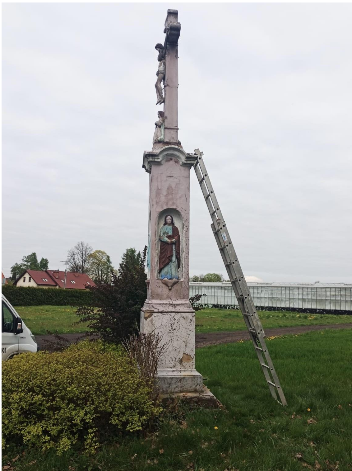
Fot. nr 2. Stan zachowania obiektu przed konserwacją, widok na lewy bok pomnika. Fot. Katanga, kwiecień 2024 r.
