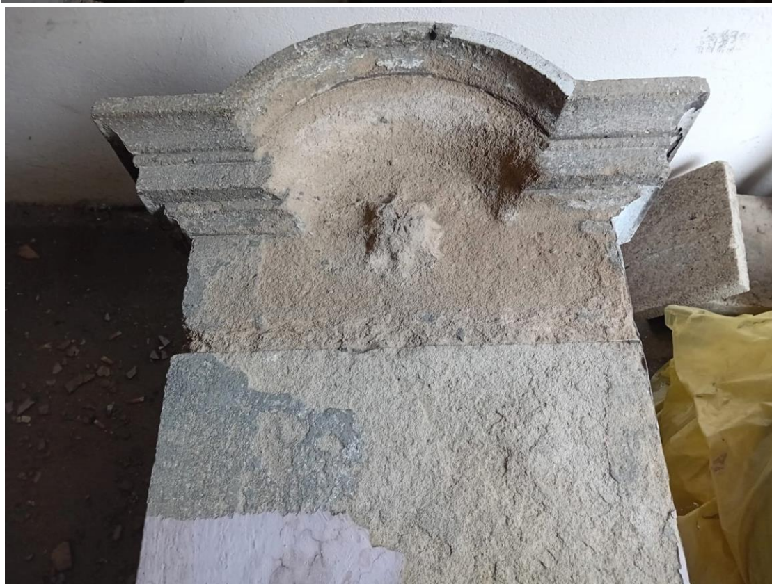
Fot. nr 21-22. Ujęcie na elementy górnej części cokołu – dobrze widoczny stan zachowania powłoki malarskiej, wyraźna warstwa szlichty cementowej oraz znaczna dezintegracja granularna substancji kamienia. Fot. G. Mienkiewicz, czerwiec 2024 r.
