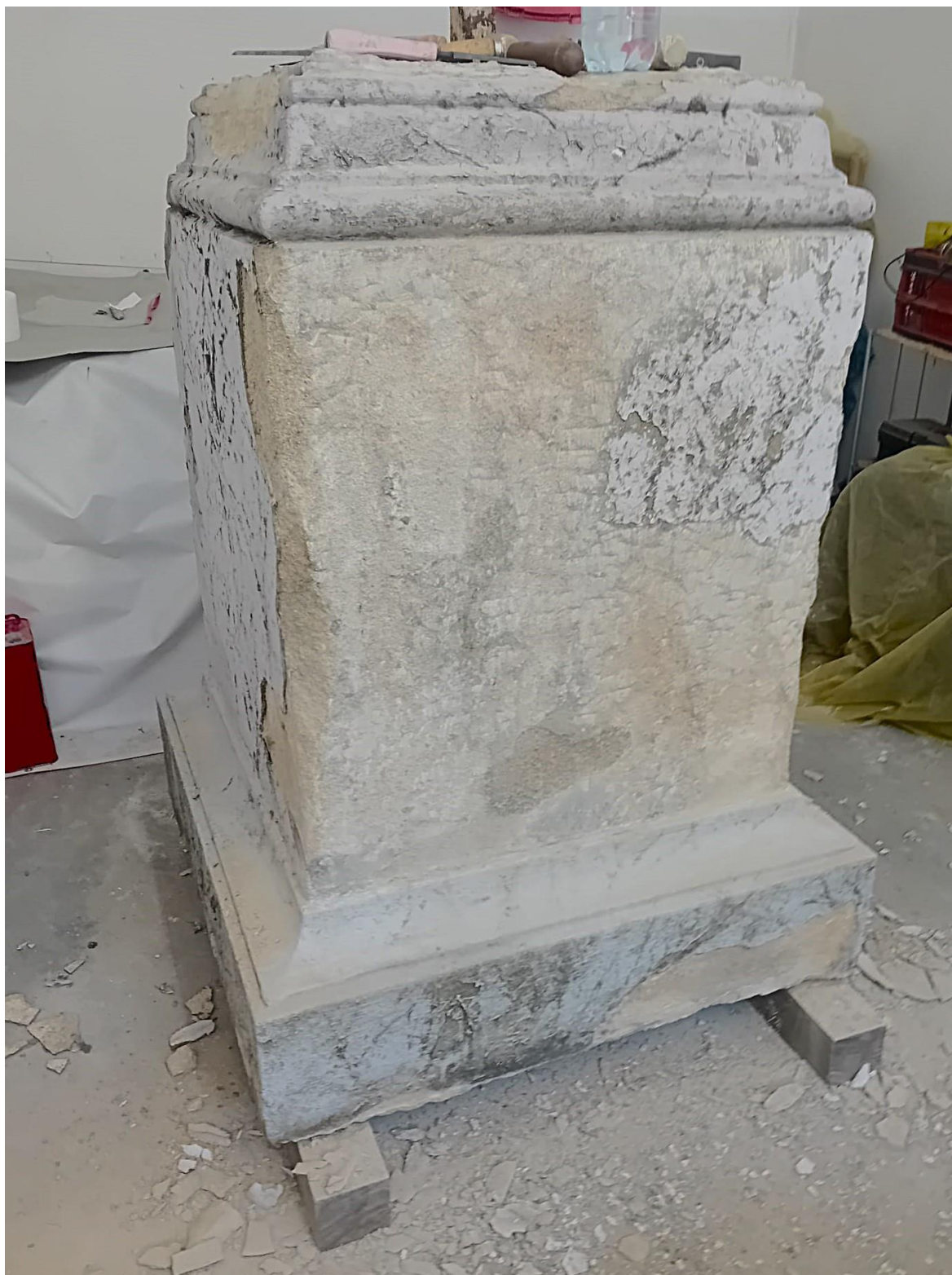
Fot. nr 31. Ujęcie na dolny element cokołu– dobrze widoczny stan zachowania kamienia w trakcie oczyszczenia z powłok malarskich i szlicht cementowych, wyraźna erozja lica substancji kamienia połączona z dezintegracją granularną. Fot. G. Mienkiewicz, czerwiec 2024 r.
