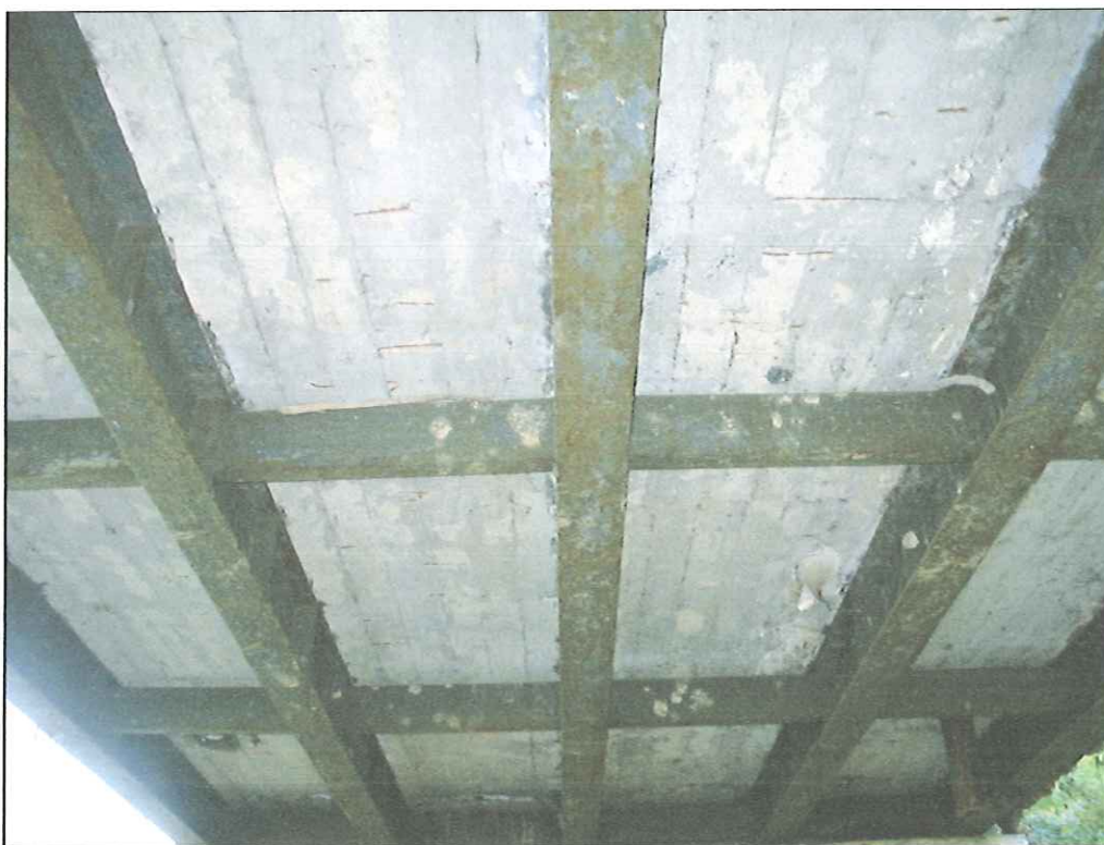
Fot. 18. Spód ustroju nośnego – przęsło Nr 2. Zanieczyszczenia, osady, złuszczenia przypowierzchniowej warstwy betonu. Widoczna korozja prętów na spodzie płyty świadcząca o braku betonowej otuliny. Widoczne nierówności po deskowaniu klasycznym.
