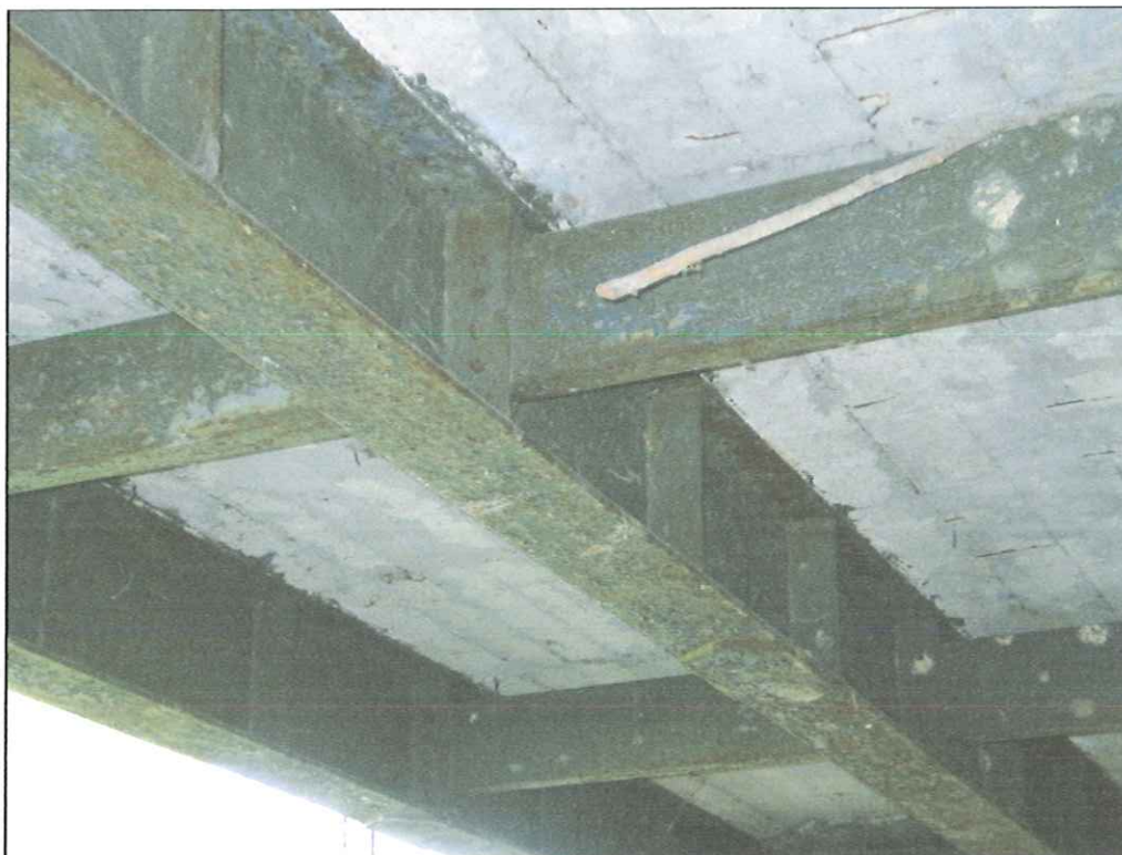
Fot. 21. Dźwigary blachownicowe - złuszczenia powłoki malarskiej oraz ogniska korozji powierzchniowej – przęsło Nr 2.
