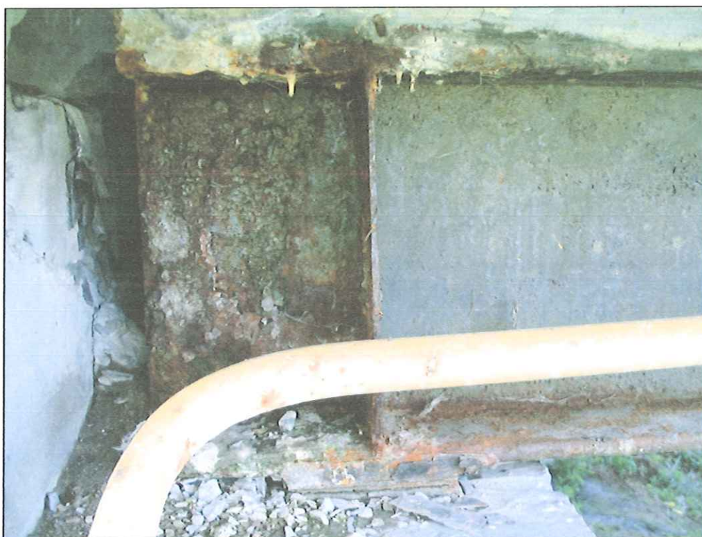
Fot. 22. Bok blachownicy po stronie dolnej wody (DW) – przęsło Nr 2. Korozja wżerowa końców blachownicy w wyniku ciągłego przecieku wody. Brak na obiekcie urządzeń dylatacyjnych przyczynia się do powstawania tego typu uszkodzeń.
