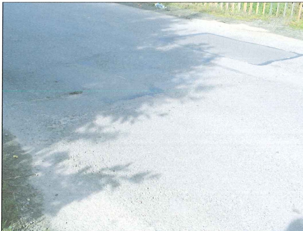
Fot. 7. Nawierzchnia na dojeździe od strony drogi krajowej DK nr 9. Zanieczyszczenia, wegetacja roślinności na krawędzi jezdni. Zaniżenie nawierzchni na dojeździe świadczące prawdopodobnie o braku płyt przejściowych. Spękania i ubytki asfaltu.
