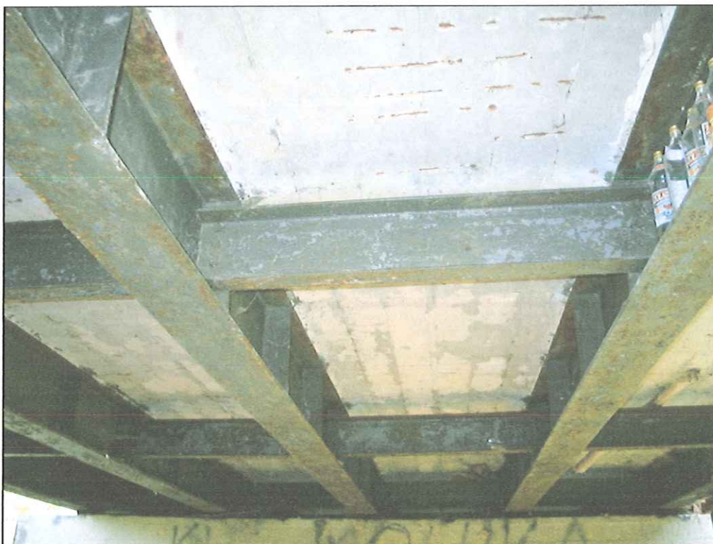
Fot. 17. Spód ustroju nośnego – przęsło Nr 1. Zanieczyszczenia, osady, złuszczenia przypowierzchniowej warstwy betonu. Widoczna korozja prętów na spodzie płyty świadcząca o braku betonowej otuliny.
