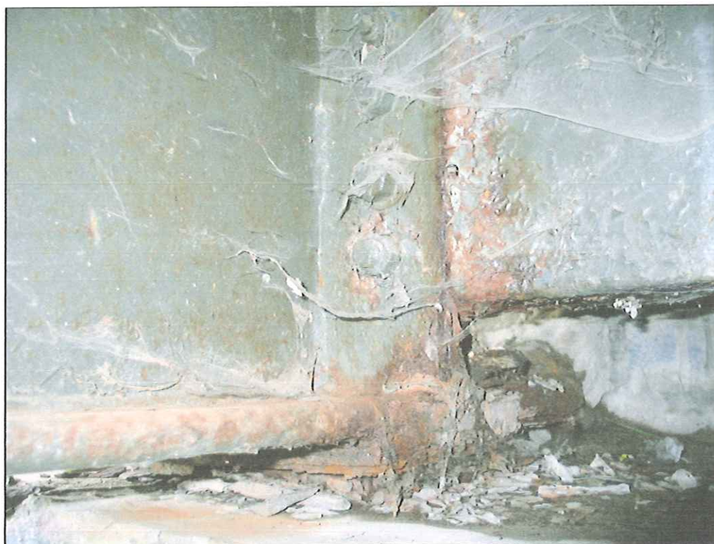
Fot. 24. Łożyska stalowe styczne od strony drogi krajowej DK nr 9. Zanieczyszczenia, zaawansowana korozja wżerowa.
