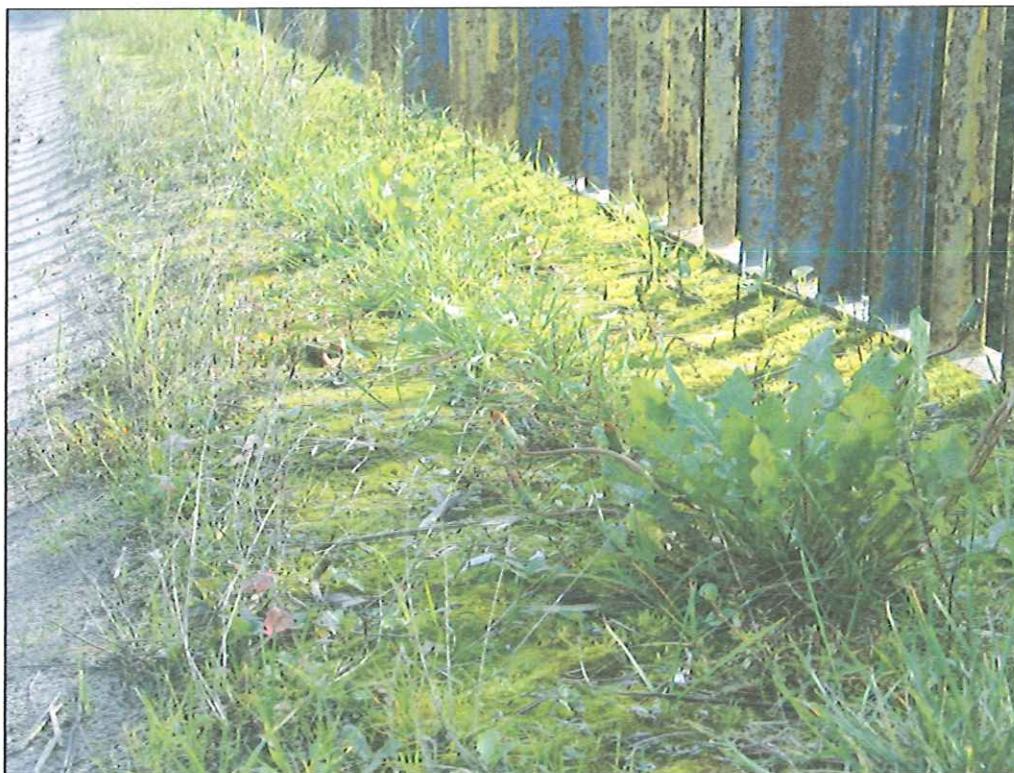
Fot. 9. Pobocze po stronie górnej wody (GW). Wieloletnie zaniedbanie obiektu w ramach bieżącego utrzymania obiektu. Brak bieżącego utrzymania obiektu.
