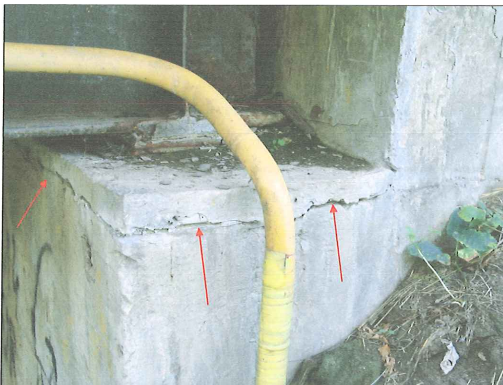
Fot. 28. Rozwarstwienie podlewki łożysk od strony m. Szewna / dolnej wody (DW).
