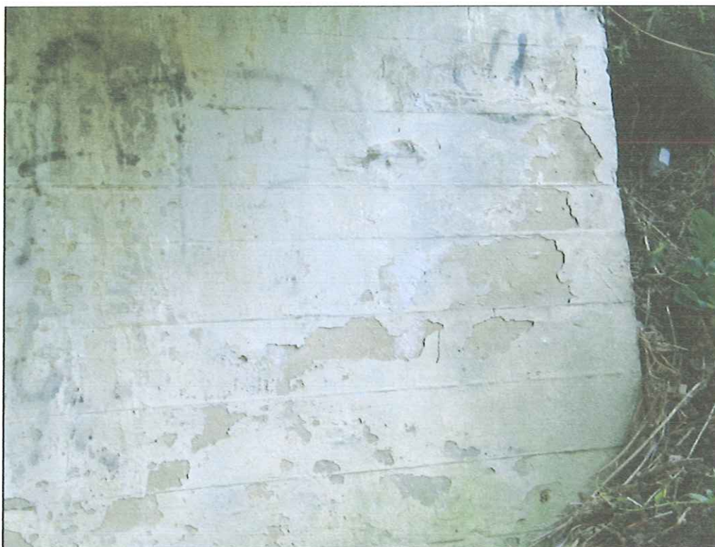
Fot. 30. Korpus przyczółka od strony drogi krajowej DK nr 9 / górna woda (GW). Złuszczenia przypowierzchniowej warstwy betonu.
