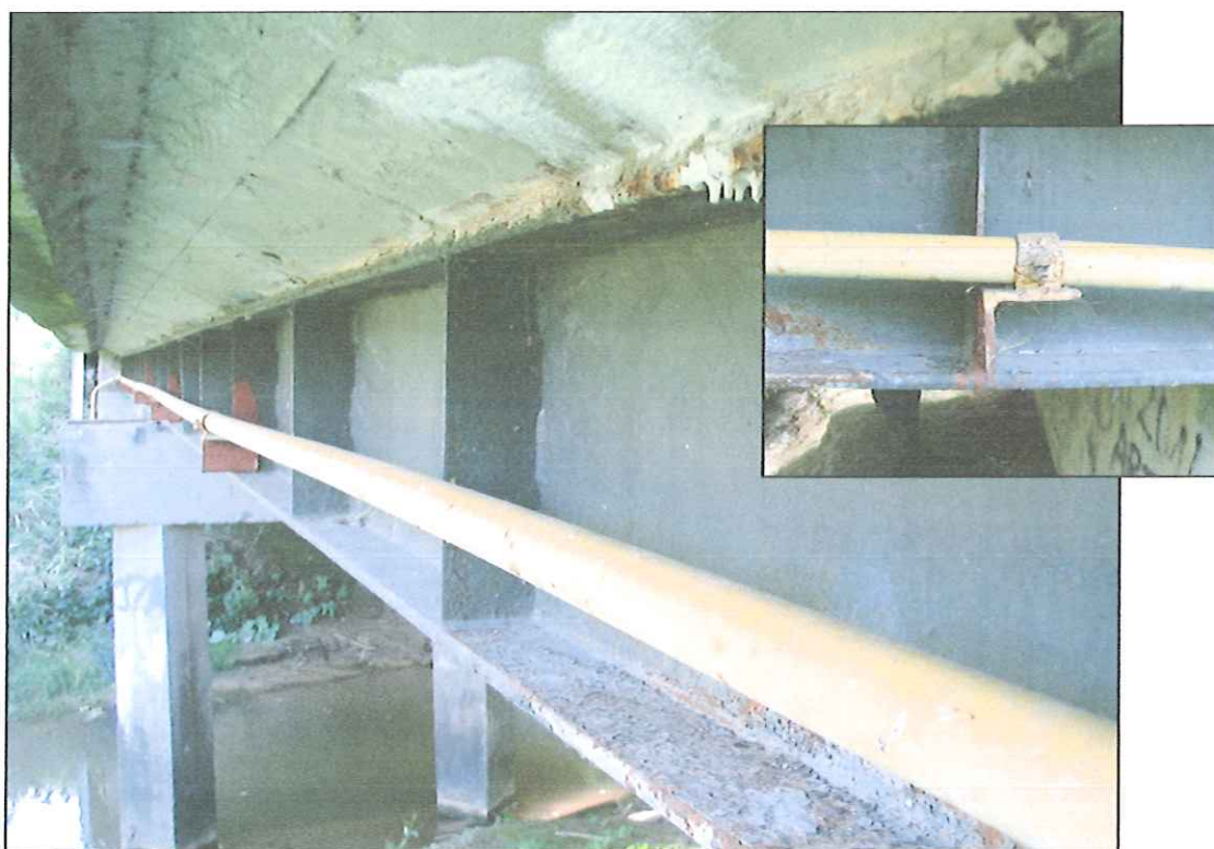
Fot. 34. Urządzenie obce (rura gazowa) po stronie dolnej wody (DW). Ogólne zanieczyszczenia rury gazowej. Korozja kątownika wsporcze przyspawana do żeberek dźwigara.
