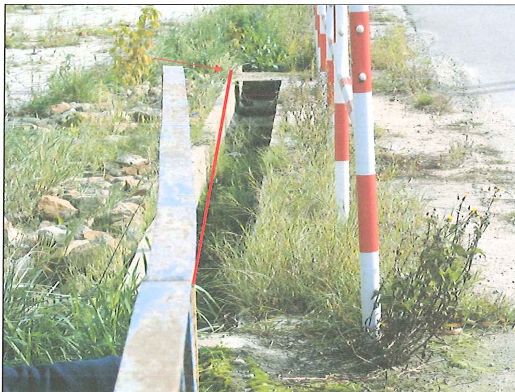
Fot. 12. Przemieszczenie balustrady szczeblinkowej od strony drogi krajowej DK nr 9 / dolnej wody (DW) w wyniku uderzenia pojazdu. Brak zamocowania balustrady. Ubytki powłoki malarskiej oraz postępująca korozja wżerowa.
