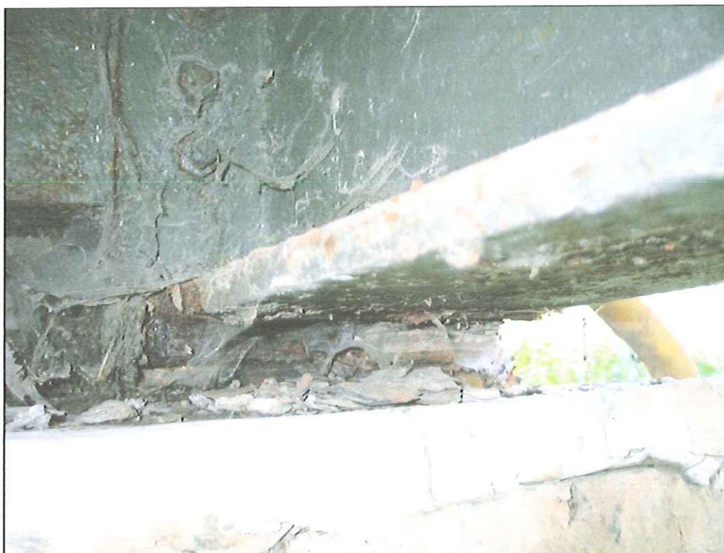
Fot. 23. Łożyska stalowe styczne od strony m. Szewna / dolna woda (DW). Zanieczyszczenia, zaawansowana korozja wżerowa.
