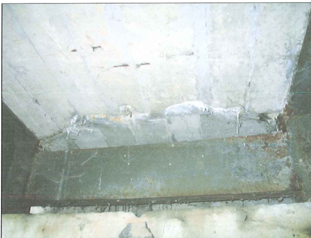
Fot. 25. Ława podłożyskowa od strony drogi krajowej DK nr 9 – przęsło Nr 2. Zanieczyszczenia, osady, wylugowania i wykwity wapienne w postaci stalaktytów świadczące o penetracji wody z poziomu jezdni i/lub z poziomu izolacji przeciwwodnej. Brak na obiekcie urządzeń dylatacyjnych przyczynia się do powstawania tego typu uszkodzeń.
