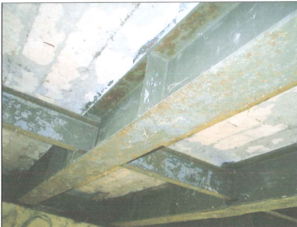
Fot. 19. Blachownica stalowa – złuszczenia powłoki malarskiej na całej powierzchni rusztu stalowego – przęsło Nr 1.
