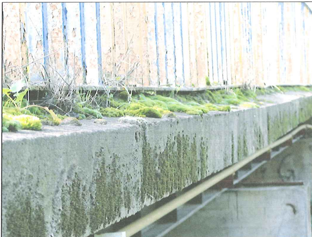
Fot. 13. Gzyms po stronie dolnej wody (DW). Zanieczyszczenia, osady, wegetacja roślinności (mchu). Lokalne ubytki i porowatości betonu.
