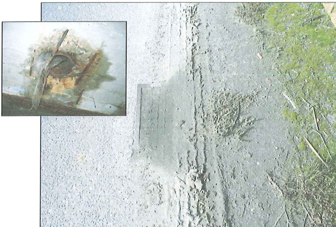
Fot. 15. Niedrożny wpust żeliwny po stronie dolnej wody (DW) – przęsło Nr 1. Intensywne zanieczyszczenia powodują całkowitą niedrożność odwodnienia. Ubytki betonowej otuliny i korozja zbrojenia w obrębie krućca wpustu żeliwnego.
