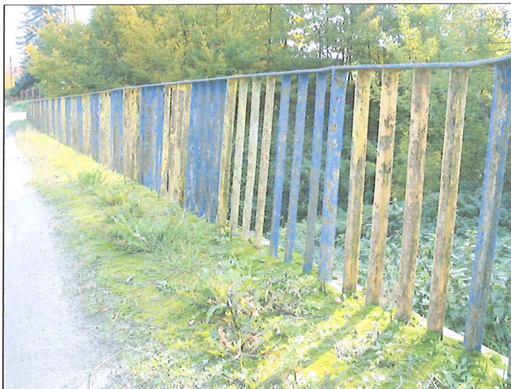
Fot. 10. Balustrada szczepinkowa po stronie górnej wody (GW). Ubytki powłoki malarskiej oraz postępująca korozja wżerowa na całej długości.
