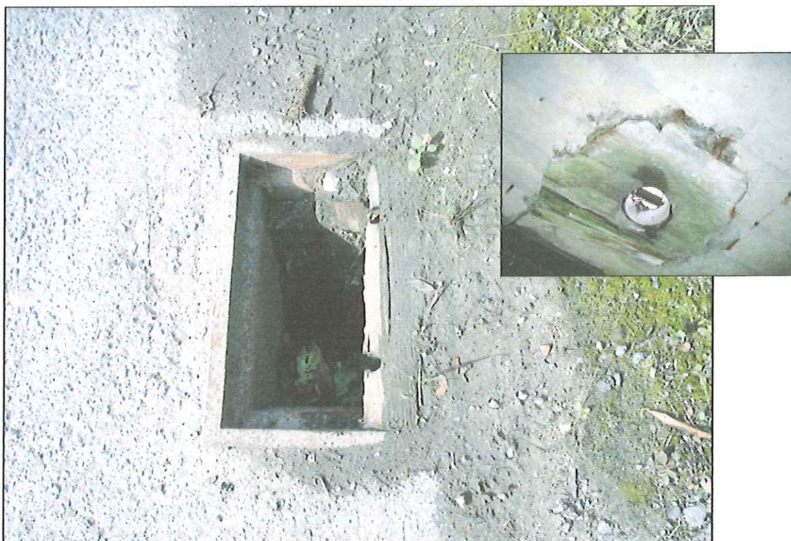
Fot. 14. Wpust żeliwny po stronie dolnej wody (DW) – przęsło Nr 2. Brak kratki we wpuszcie (zatkane deskami) stanowi zagrożenie dla bezpieczeństwa ruchu. Brak rury spustowej. Nieudolna naprawa wokół wpustu żeliwnego.
