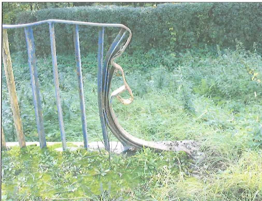
Fot. 11. Deformacja balustrady szczeblinkowej od strony m. Szewna / górnej wody (GW) w wyniku uderzenia pojazdu. Ubytki powłoki malarskiej oraz postępująca korozja wżerowa.
