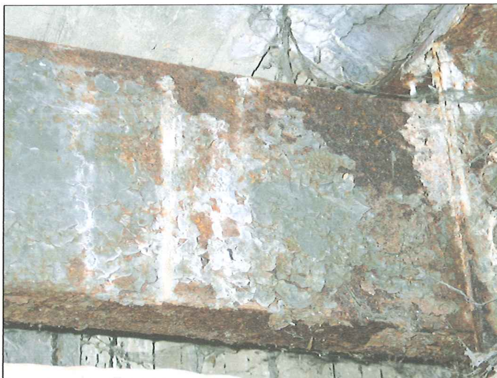
Fot. 26. Poprzecznica przęsłowa od strony drogi krajowej DK nr 9 – przęsło Nr 2. Zanieczyszczenia, osady, wylugowania wapienne na końcach płyty. Występujące uszkodzenia świadczą o awaryjnym stanie izolacji przeciwwodnej. Brak na obiekcie urządzeń dylatacyjnych przyczynia się do powstawania tego typu uszkodzeń. Korozja wżerowa poprzecznicy.
