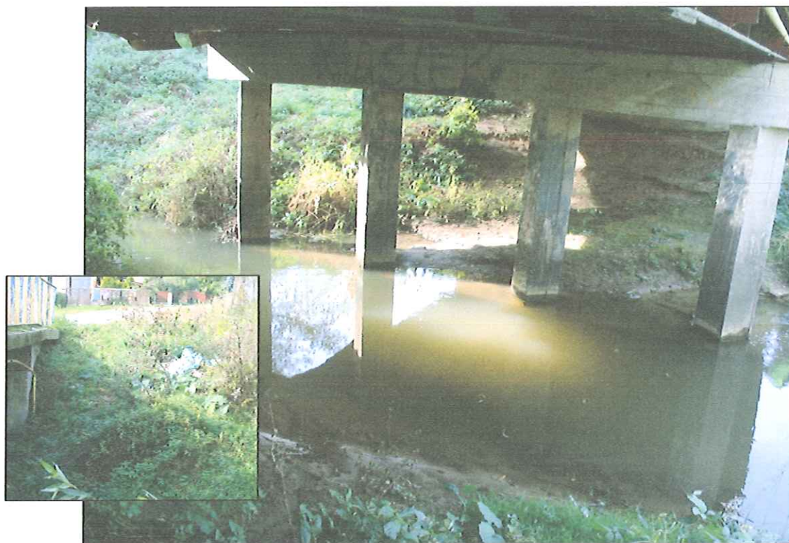
Fot. 32. Przestrzeń podmostowa. Ogólne zanieczyszczenia i bujna wegetacja roślinności po stronie dolnej wody (DW).
