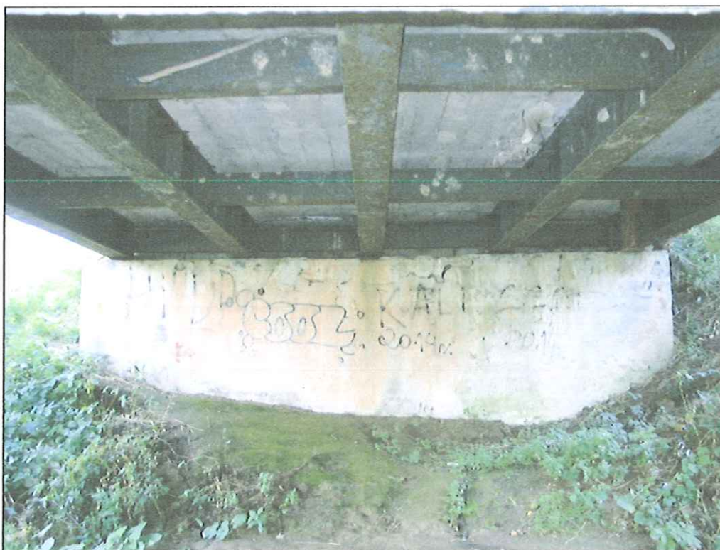
Fot. 29. Korpus przyczółka od strony drogi krajowej DK nr 9. Zanieczyszczenia w postaci „graffiti” oraz złuszczenia przypowierzchniowej warstwy betonu.
