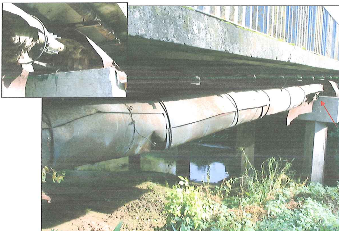
Fot. 33. Urządzenie obce (najprawdopodobniej rura wodociągowa) po stronie górnej wody (GW). Zanieczyszczenia, korozja oraz ubytki rury osłonowej. Należy zgłosić właścicielowi o konieczności konserwacji urządzenia obcego.
