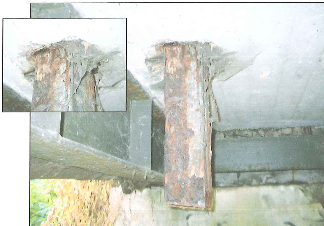
Fot. 16. Rura spustowa po stronie górnej wody (GW) – przęsło Nr 1. Ubytki betonowej otuliny i korozja zbrojenia w obrębie krućca wpustu żeliwnego. Zanieczyszczenia i osady na rurze spustowej.
