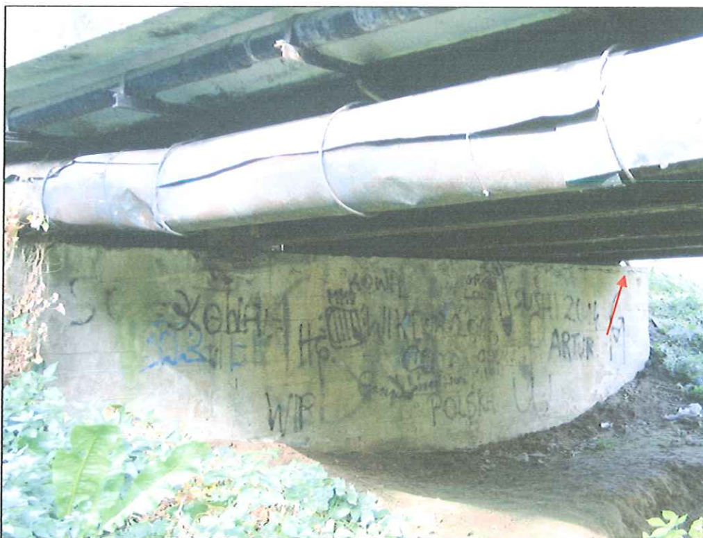
Fot. 27. Korpus przyczółka od strony m. Szewna. Zanieczyszczenia w postaci „graffiti” oraz rozwarstwienie podlewki łożysk od strony m. Szewna / dolnej wody (DW).
