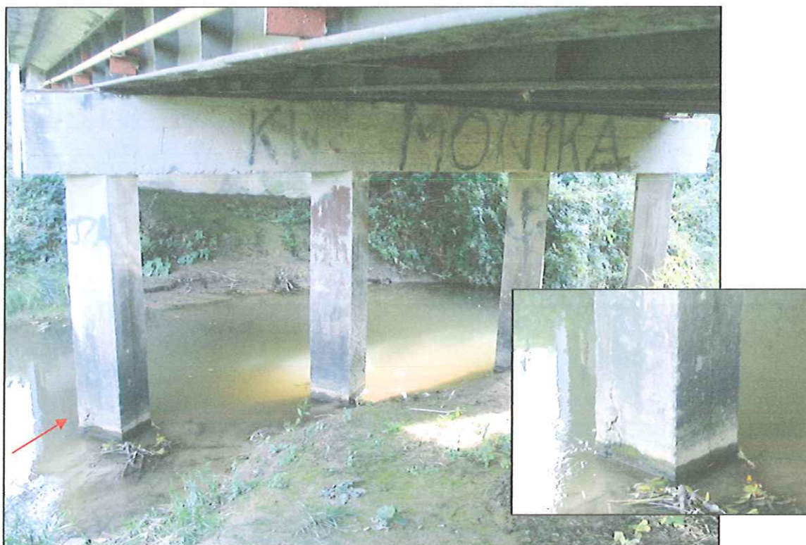
Fot. 31. Filary od strony m. Szewna. Liczne zanieczyszczenia w postaci „graffiti” na ocze pie filara. Zarysowanie słupa od strony dolnej wody (DW) na wysokości zmiennego poziomu wody.
