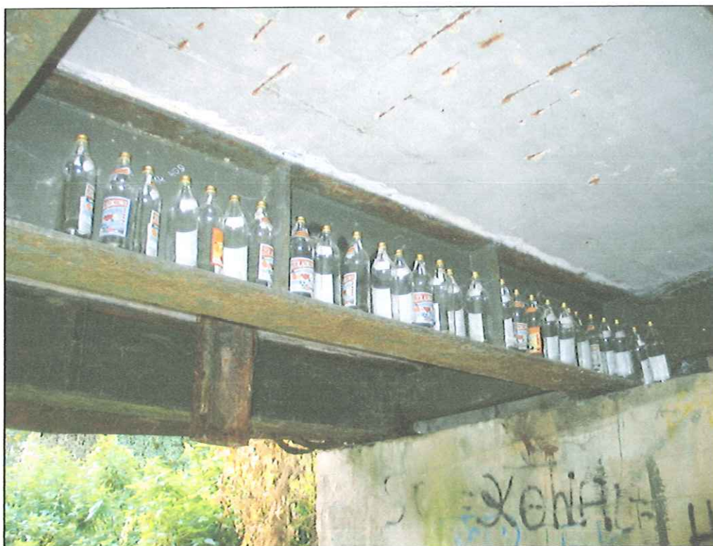
Fot. 20. Spód ustroju nośnego – przęsło Nr 1 od strony m. Szewna. Zanieczyszczenia w postaci „butelek” ustawionych na belce Nr 2 od strony górnej wody (GW). Złuszczenia powłoki malarskiej na całej powierzchni rusztu stalowego.
