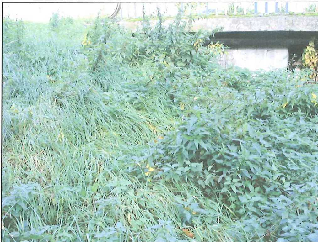
Fot. 5. Stożek gruntowy po stronie m. Szewna – górnej wody (GW). Zanieczyszczenia, nadmierna wegetacja roślinności. Brak bieżącego utrzymania obiektu.
