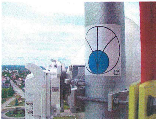
Załącznik nr 1: Dokumentacja fotograficzna instalacji radiokomunikacyjnej.
