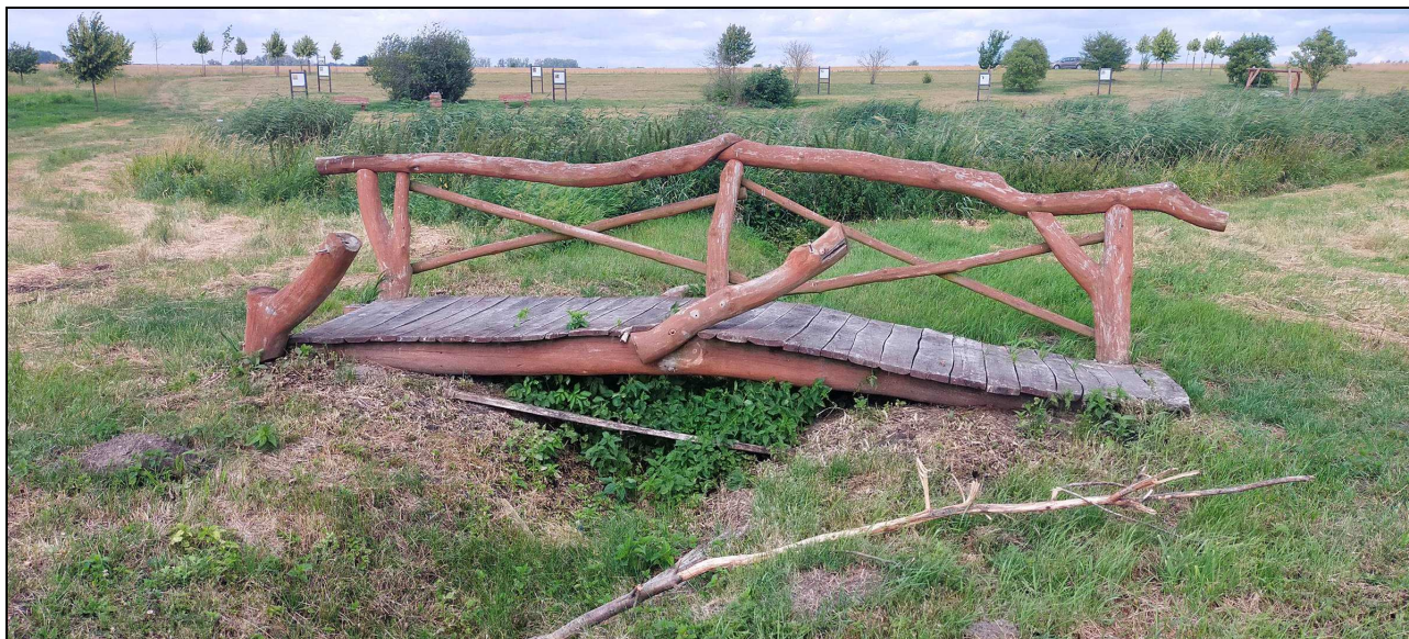
Fot.5 Mostek drewniany przeznaczony do demontażu i wymiany na nowy (źródło: inwentaryzacja z dnia 23-07-2023r.)
