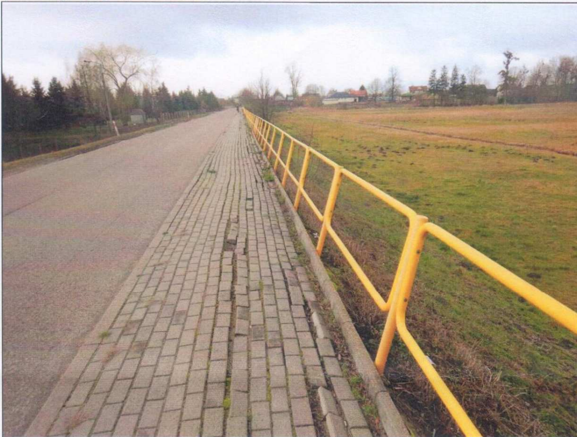
Górna część osuwiska z widocznymi uszkodzeniami infrastruktury.
