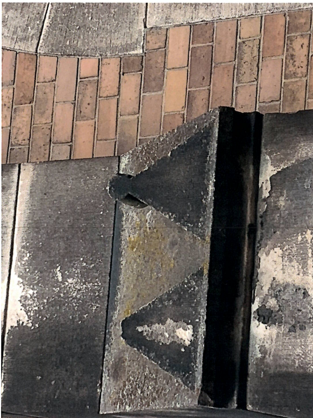
Fot. 9. Kościół pw. Matki Boskiej Częstochowskiej, zespół kaplicy mauzoleum rodu Henckel von Donnersmarck, 1896-1905 r. Widoczne łuszczenie się warstwy przypowierzchniowej kamienia. Stan przed konserwacją.
