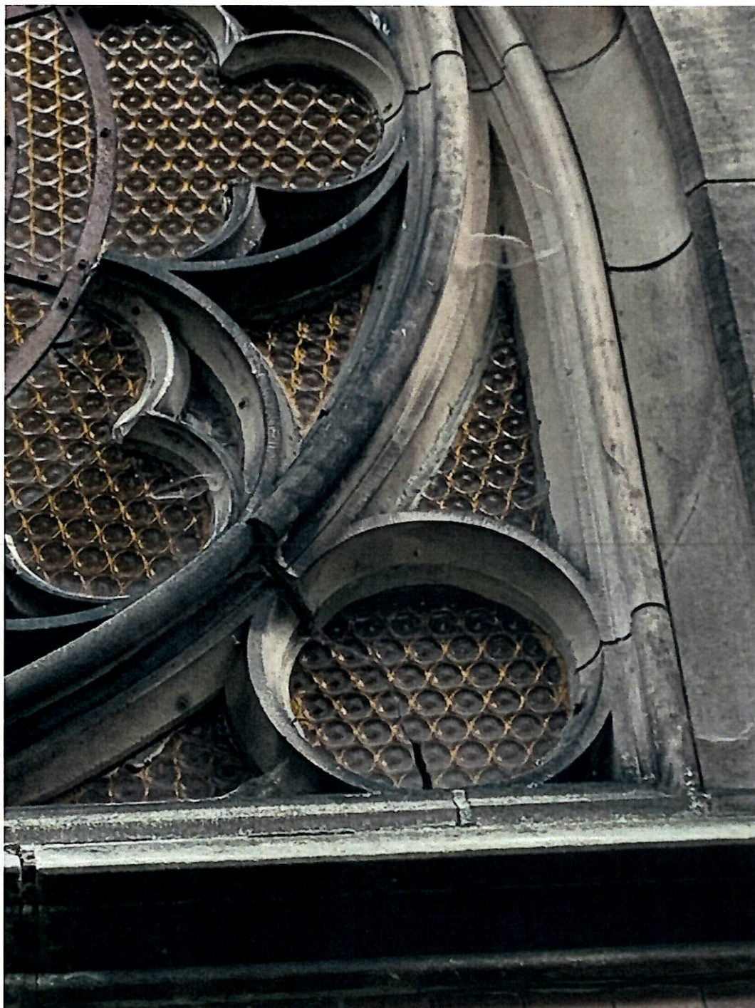
Fot. 6. Kościół pw. Matki Boskiej Częstochowskiej, zespół kaplicy mauzoleum rodu Henckel von Donnersmarck, 1896-1905 r. Widoczne zabrudzenie detalu rzeźbiarskiego z piaskowca. Stan przed konserwacją.
