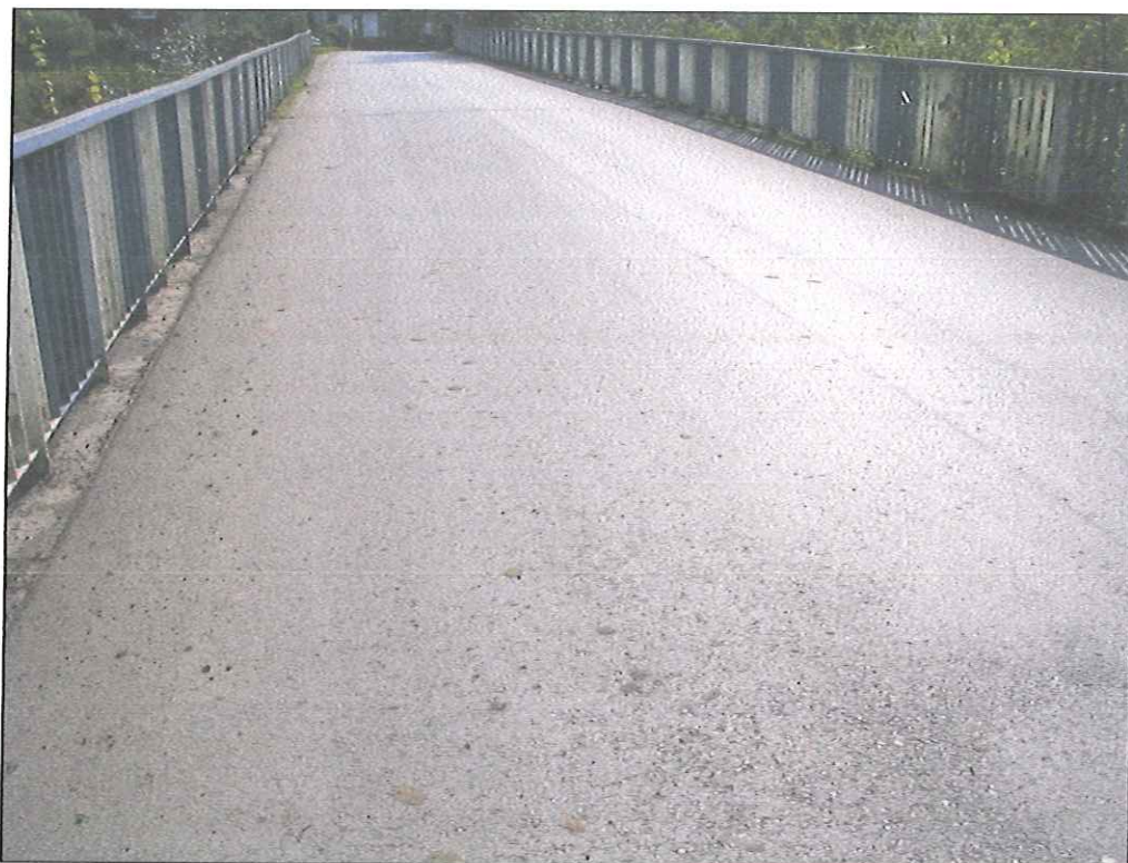
Fot. 8. Nawierzchnia na obiekcie. Zanieczyszczenia i wegetacja roślinności na krawędzi jezdni. Spękania, deformacje oraz ubytki nawierzchni w miejscu, gdzie powinno znajdować się szczelne urządzenie dylatacyjne. Zaniżenia nawierzchni nad podporami pośrednimi przyczyniają się do wzbudzania drgań dynamicznych.
