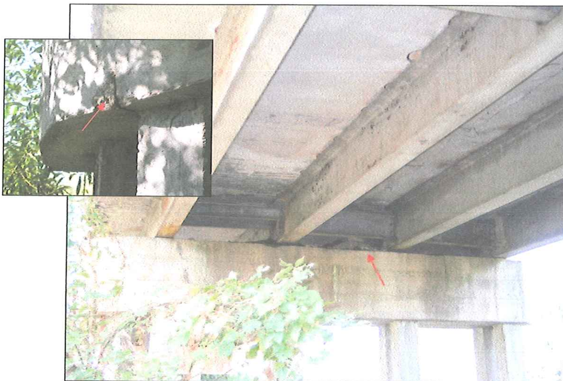
Fot. 28. Podpora pośrednia Nr 3. Zanieczyszczenia, zacieki i osady na oczepie filara. Lokalna korozja zbrojenia i ubytki betonu. Zanieczyszczenia na oczepie spadające przez lata z poziomu jezdni.
