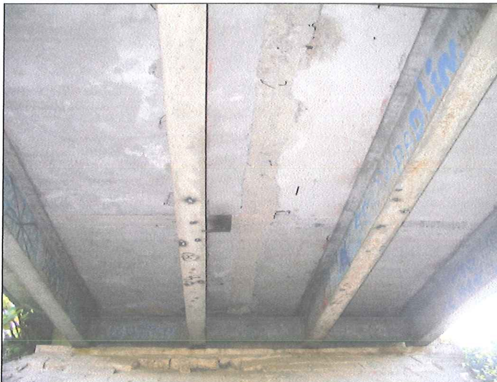
Fot. 15. Spód żelbetowej płyty prefabrykowanej - przęsło Nr 3 od strony m. Wólka Pętkowska. Ogólne zanieczyszczenia płyty prefabrykowanej. Widoczne zamki zespajające z pozostawionymi korodującymi prętami, które służyły do podwieszenia szalunku.
