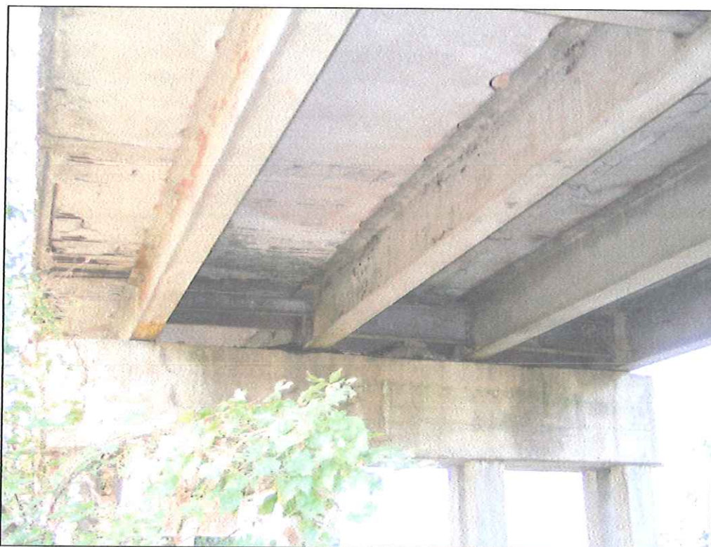
Fot. 14. Widok na podporę pośrednią Nr 3 od strony m. Wólka Pętkowska. Widoczne zacieki świadczące o konieczności uszczelnienia szczeliny dylatacyjnej i zabudowy urządzenia dylatacyjnego. Lokalnie stężenia poprzeczne stanowią poprzecznice o wysokości h=15\text{cm} zamiast h=30\text{cm}
