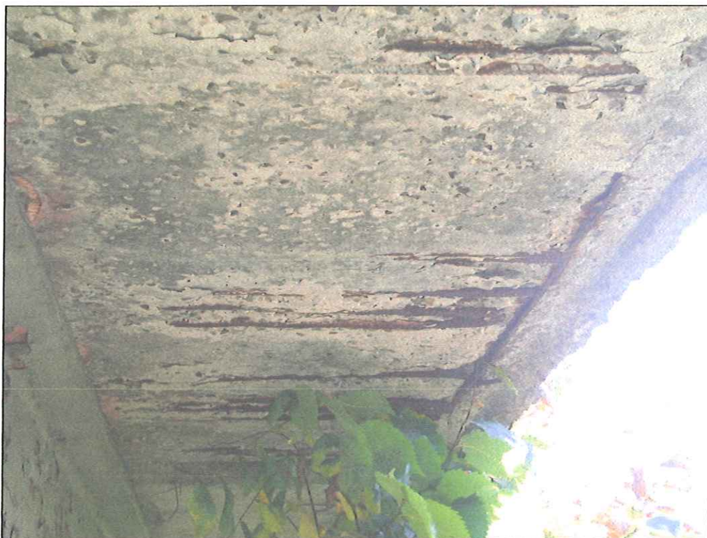
Fot. 18. Spód wspornika od strony górnej wody (GW) – przęsło Nr 1. Liczne odspojenia i ubytki przypowierzchniowej warstwy betonu. Odsłonięte i skorodowane zbrojenie wynikiem zbyt cienkiej otuliny zbrojenia.
