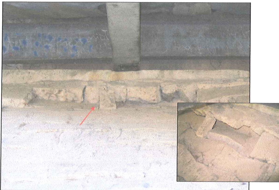
Fot. 6. Umocnienie pod obiektem z dybli betonowych typu DC-15 od strony m. Wólka Pętkowska. Lokalne osiadanie i przemieszczenia prefabrykatów.
