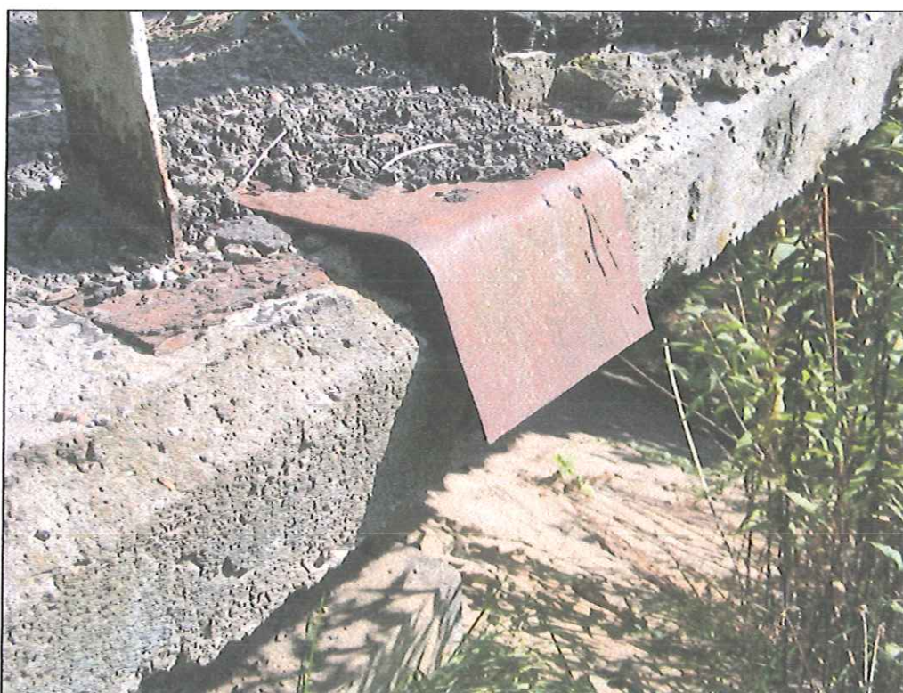
Fot. 26. Blacha osłonowa szczeliny dylatacyjnej od strony drogi wojewódzkiej DW nr 754 – górnej wody (GW). Zanieczyszczenia, przemieszczenia i korozja blachy osłonowej.
