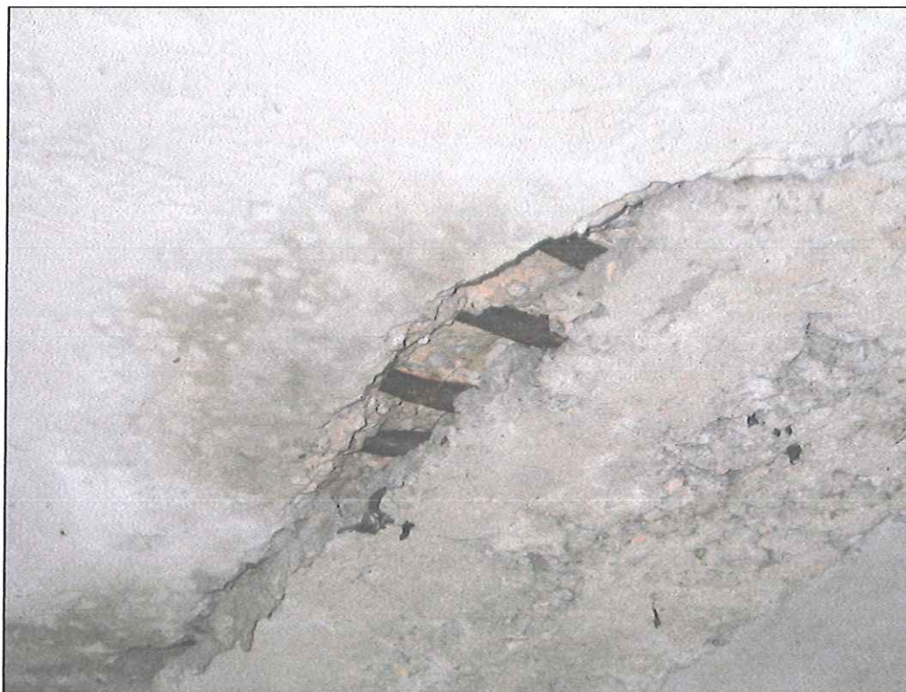
Fot. 16. Spód płyty prefabrykowanej – przęsło Nr 3 od strony m. Wólka Pętkowska. Widoczne odspojenia i ubytki betonu. Korozja odsłoniętych prętów zbrojeniowych.
