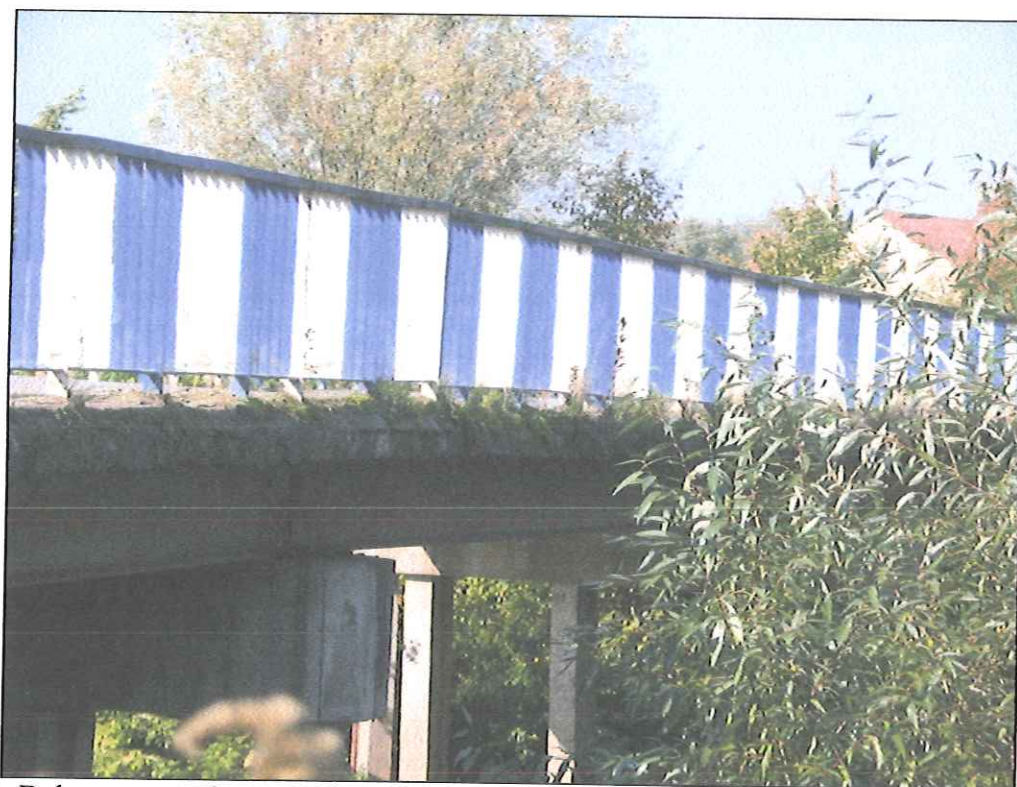
Fot. 12. Bok gzymsu od strony dolnej wody (DW). Zanieczyszczenia z intensywną wegetacją roślinności. Osady, wykwity, korozja i ubytki betonu. Korodujące odsłonięte pręty zbrojeniowe.
