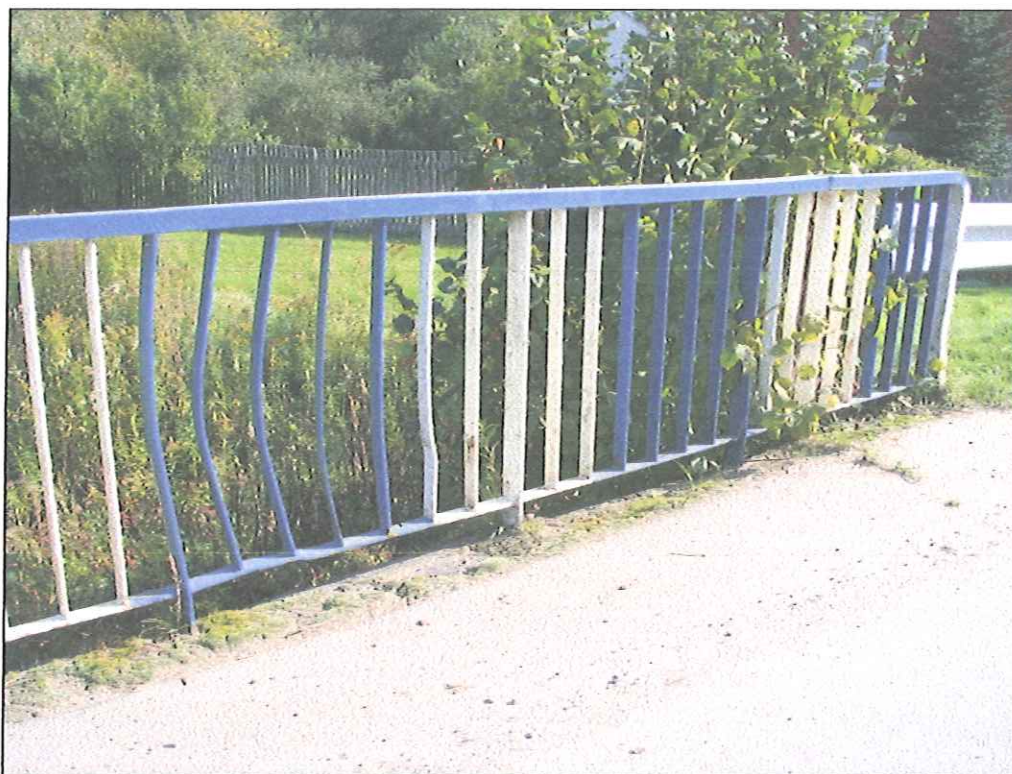
Fot. 10. Balustrada szczepinkowa od strony dojazdu od m. Wólka Pętkowska – dolnej wody (DW). Deformacje szczepinek balustrady powstałe w wyniku uderzenia pojazdu.
