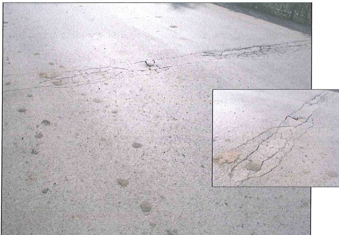
Fot. 25. Deformacja nawierzchni, spękania siatkowe, rysy i ubytki asfaltu nad szczeliną dylatacyjną – podpora pośrednia Nr 3. Na oczepie filara widoczne zanieczyszczenia spadające z poziomu jezdni.
