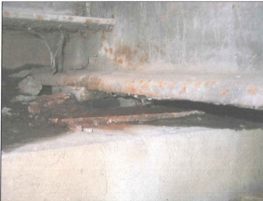
Fot. 23. Łożysko elastomerowe na korpusie przyczółka od strony drogi wojewódzkiej DW nr 754. Zanieczyszczenia oraz deformacja łożyska. Skorodowana blacha pod łożyskiem elastomerowym.
