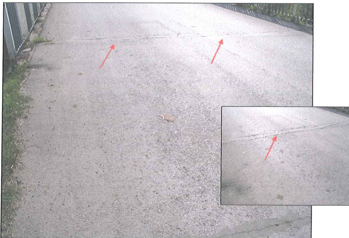
Fot. 7. Nawierzchnia na dojeździe od strony drogi wojewódzkiej DW nr 754. Zanieczyszczenia, wegetacja roślinności po obu stronach krawędzi nawierzchni. Spękania, deformacje i ubytki nawierzchni w miejscu, gdzie powinno znajdować się szczelne urządzenia dylatacyjne.
