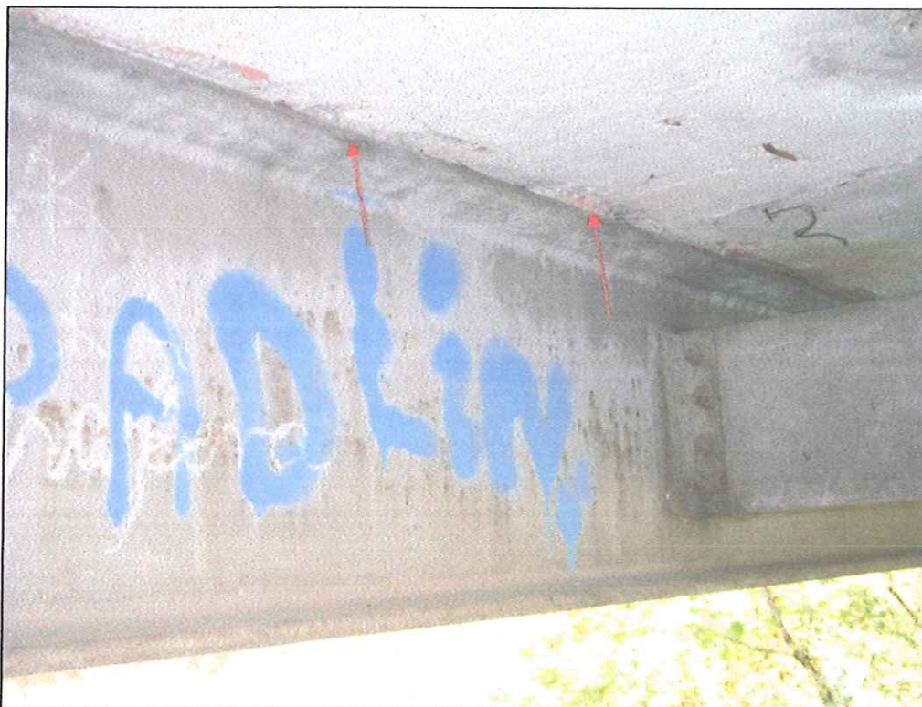
Fot. 21. Bok dźwigara – przęsło Nr 3 od m. Wólka Pętkowska. Szczeliny pomiędzy dźwigarami a płytą prefabrykowaną. Płyta zakotwiona do belek za pośrednictwem marek stalowych. Zanieczyszczenia „graffiti”, uszkodzenia powłoki antykorozyjnej.
