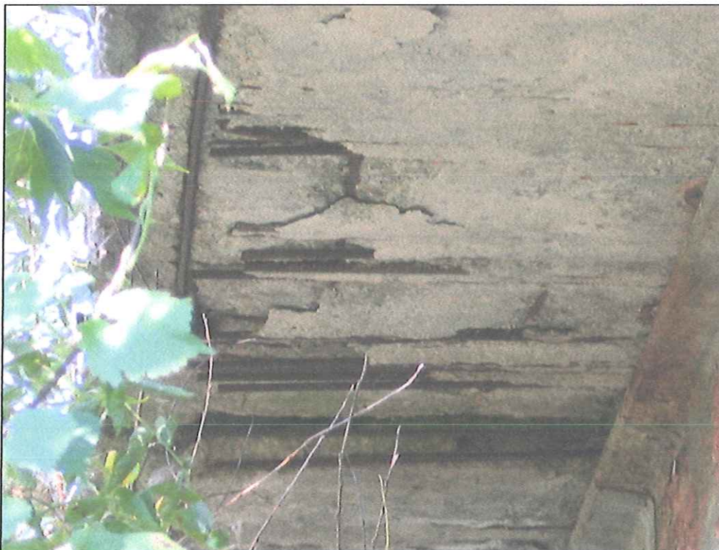
Fot. 19. Spód wspornika od strony górnej wody (GW) – przęsło Nr 3. Liczne odspojenia i ubytki betonu. Odsłonięte i skorodowane zbrojenie wynikiem zbyt cienkiej otuliny zbrojenia.
