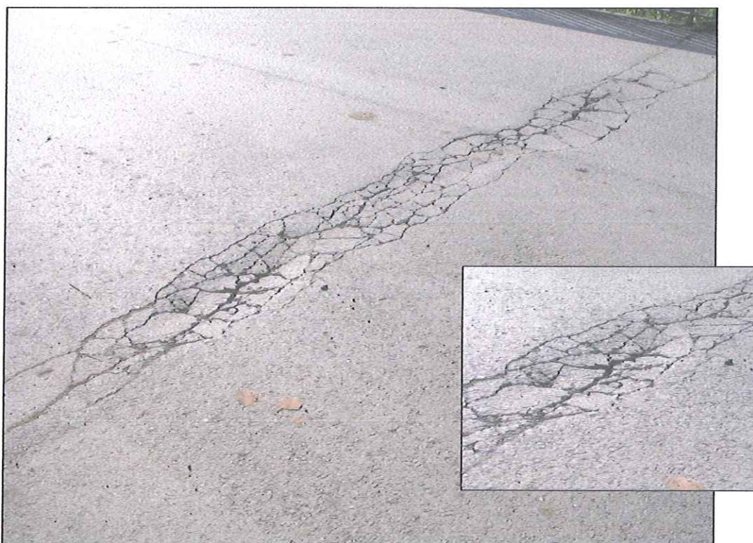
Fot. 24. Zapadnięcie nawierzchni, spękania siatkowe, rysy i ubytki asfaltu nad szczeliną dylatacyjną – podpora pośrednia Nr 2. Na oczepie filara widoczne intensywne zanieczyszczenia spadające z poziomu jezdni.
