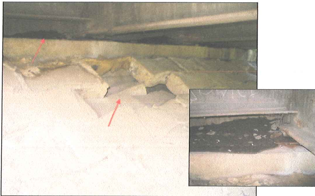
Fot. 27. Korpus przyczółka zatopiony w nasypie – widok od strony drogi wojewódzkiej DW nr 754. Intensywne zanieczyszczenia na ławie podłożyskowej. Osiadanie dybli betonowych typu DC-15.
