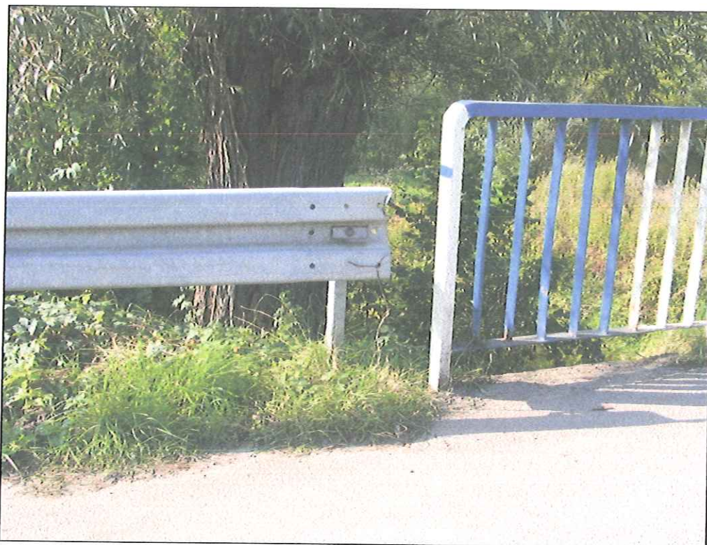
Fot. 11. Brak prawidłowego połączenia drogowej bariery ochronnej z balustradą szczeblinkową od strony m. Wólka Piętkowska – górnej wody (GW). Brak barier ochronnych na dojeździe od strony drogi wojewódzkiej DW nr 754.
