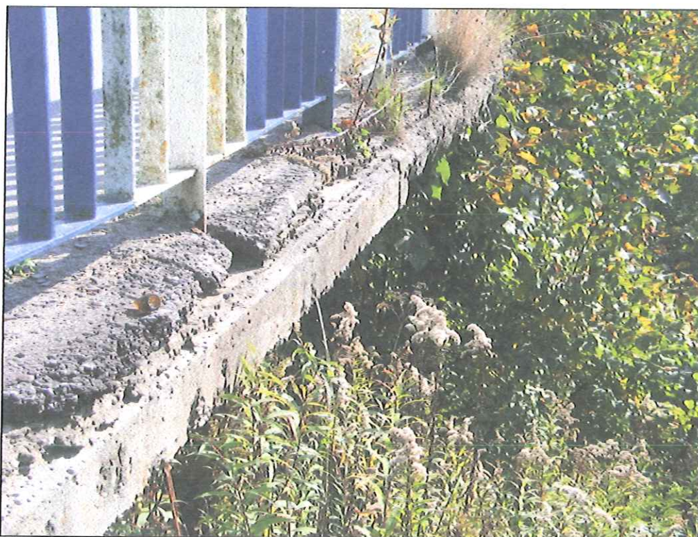
Fot. 13. Bok gzymsu od strony górnej wody (GW). Zanieczyszczenia oraz bujna wegetacja krzewów. Boczna powierzchnia gzymsów zaciéniona przez roślinność, co utrzymuje zawilgocenia i przyspiesza proces degradacji elementu.
