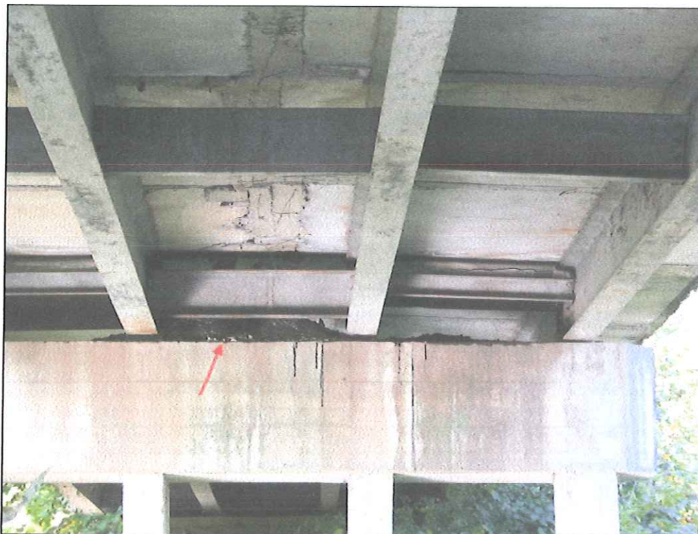
Fot. 29. Podpora pośrednia Nr 2. Zanieczyszczenia, zacieki z masy bitumicznej i osady na oczepie filara. Zanieczyszczenia spadające przez lata z poziomu jezdni.
