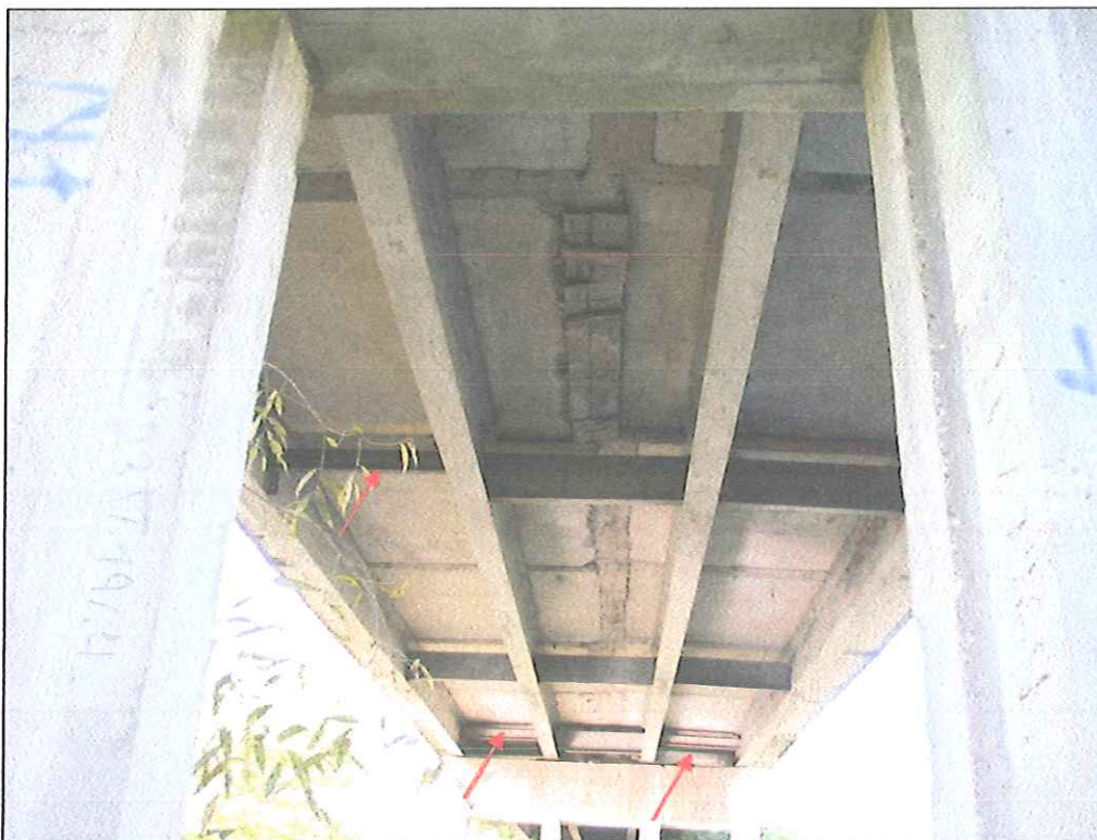
Fot. 17. Spód żelbetowej płyty prefabrykowanej – przęsło Nr 2 nurtowe. Ogólne zanieczyszczenia płyty prefabrykowanej. Pozostawione deskowanie z czasów budowy obiektu. Lokalnie stwierdzono poprzecznice ceowe h=15\text{cm} zamiast h=30\text{cm} .
