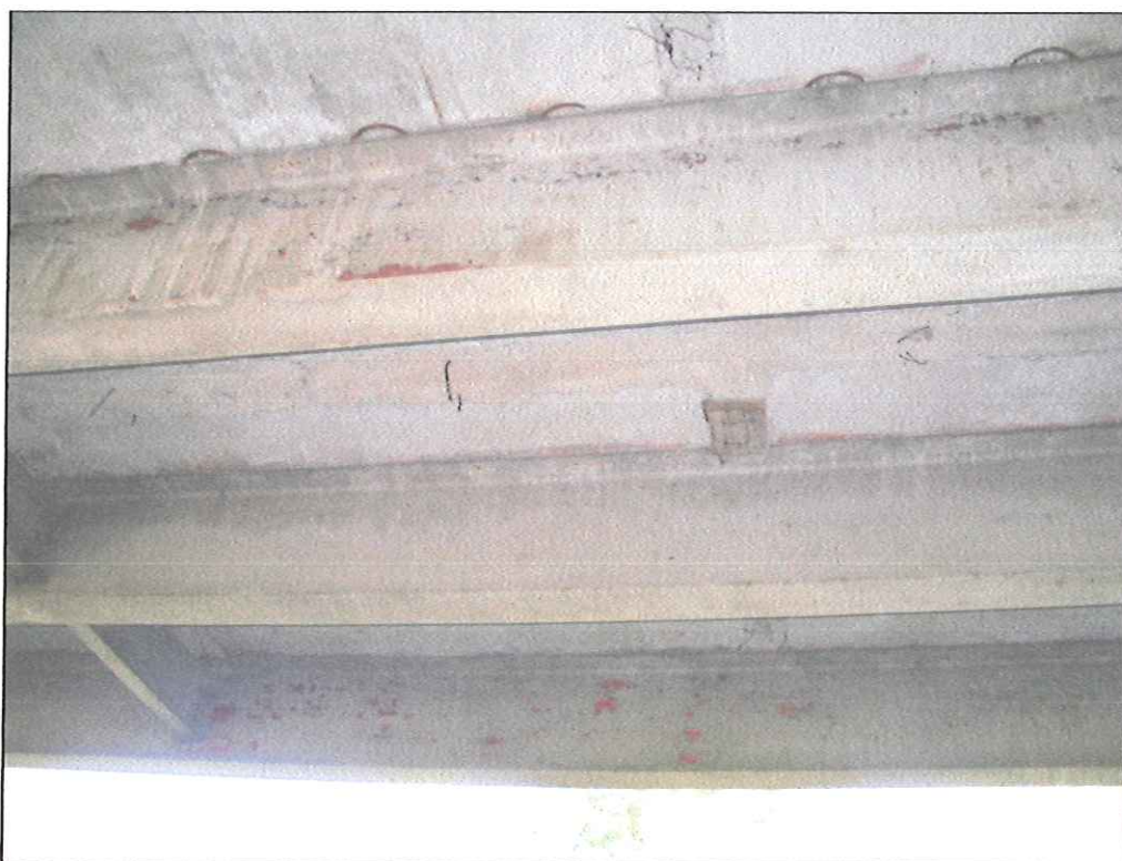
Fot. 20. Dźwigary stalowe - przęsło Nr 3 od strony m. Wólka Pętkowska. Uszkodzenie zabezpieczenia antykorozyjnego, złuszczenie powłoki malarskiej na około 30% powierzchni dźwigarów.
