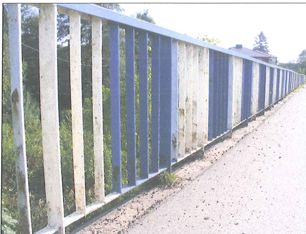
Fot. 9. Balustrada szczepinkowa od strony dolnej wody (DW). Zanieczyszczenia, uszkodzenia powłoki antykorozyjnej oraz ogniska korozji wżerowej.
