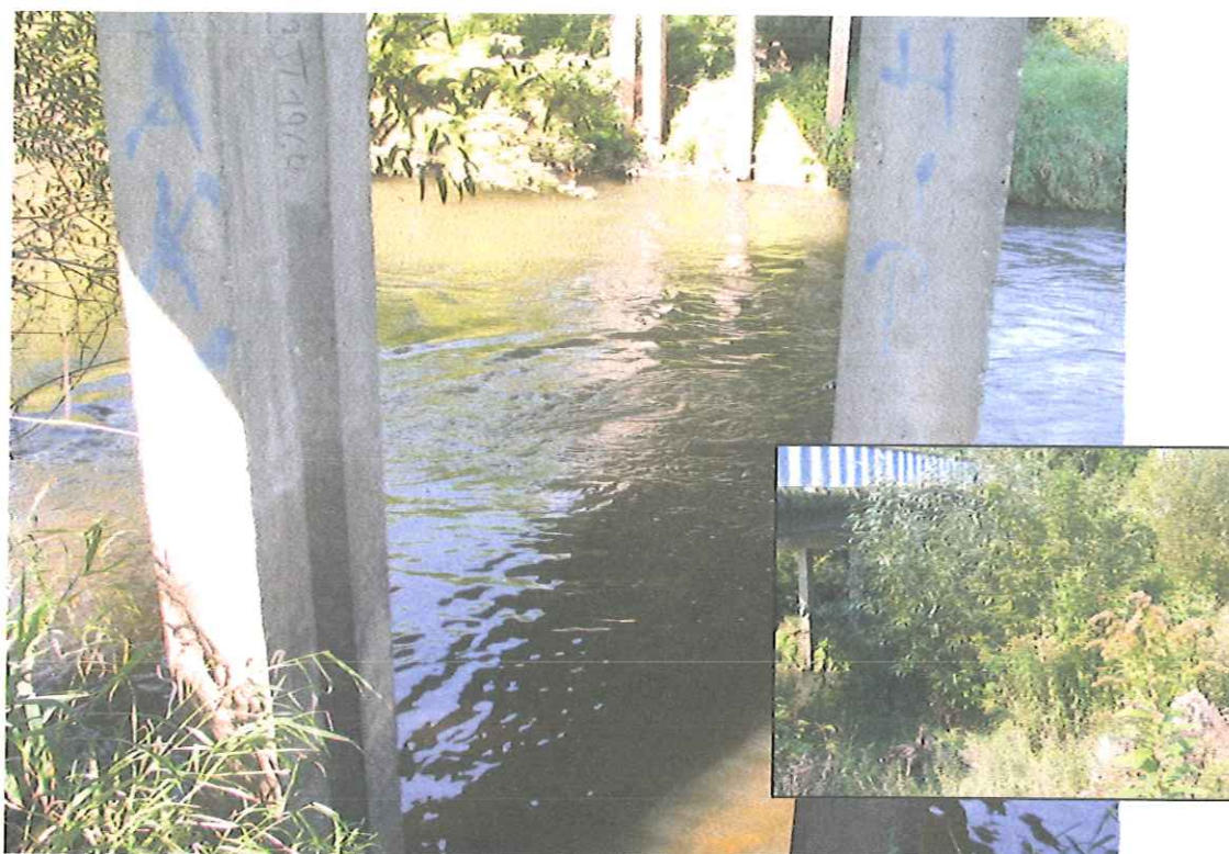
Fot. 30. Słupy filara, koryto i przestrzeń podmostowa. Pionowe i poziome rysy o rozwarości do 0,3 mm, powstałe w miejscu występowania zbrojenia. Zanieczyszczenia, bujna wegetacja roślinności (krzewów, drzew) utrudniające prawidłowy dostęp i oględziny obiektu podczas przeglądu.
