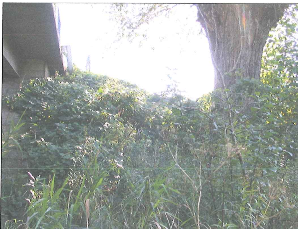
Fot. 5. Stożek od strony m. Wólka Pętkowska - górnej wody (GW). Zanieczyszczenia, nadmierna wegetacja roślinności. Brak prac porządkowych w ramach bieżącego utrzymania obiektu.
