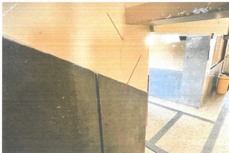
Uszkodzenie ściany w poziomie P.G i parteru po obu stronach klatki schodowej
