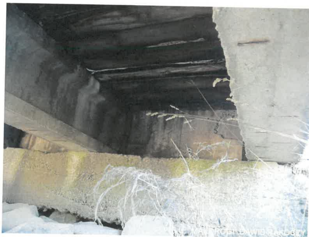
Zdj. 8 Podmyty przyczółek, korozja betonu.
