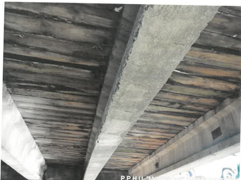
Zdj. 7 Zły stan drewnianego pomostu – korozja, ubytki.
