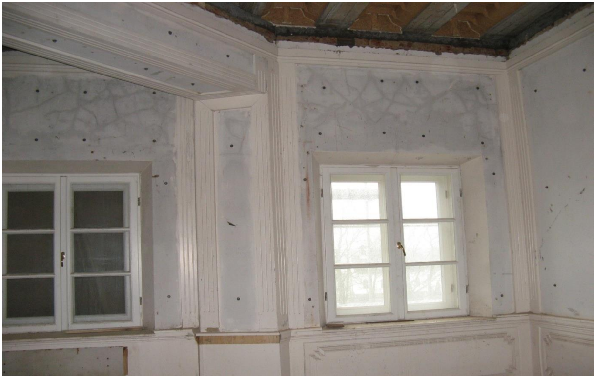
Popękane tynki na ścianach
