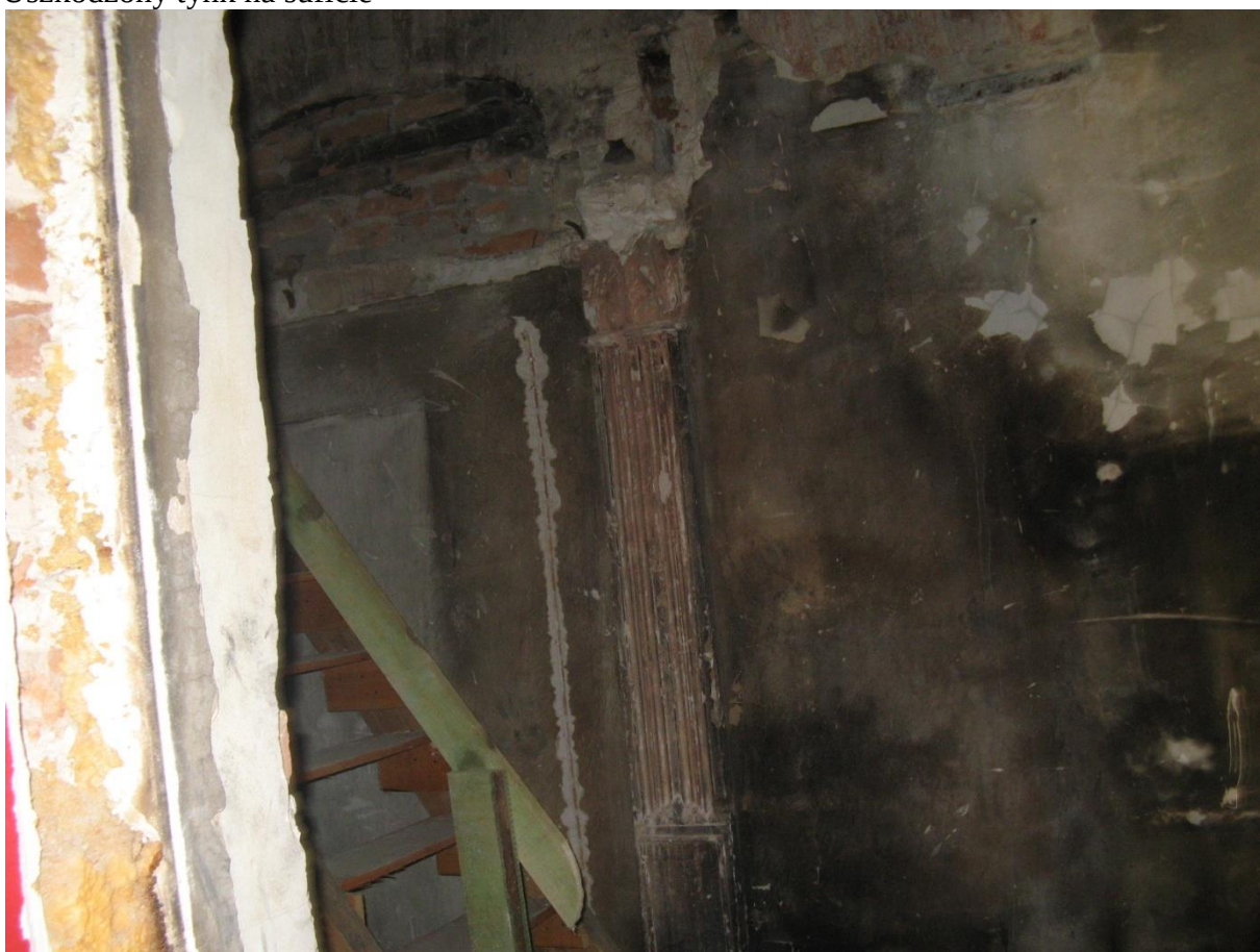
Uszkodzone spalone tynki na ścianach
