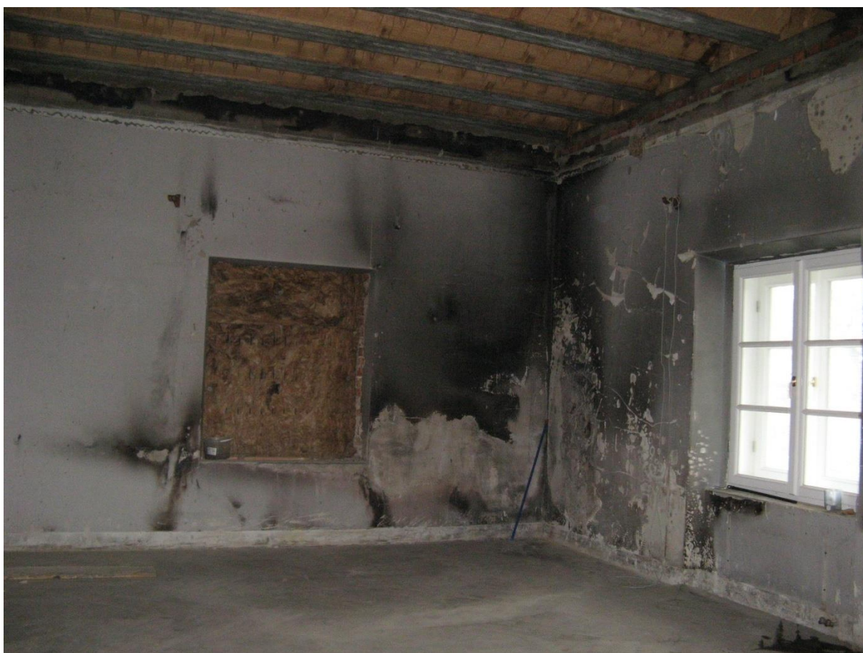
Uszkodzony tynk na ścianach
