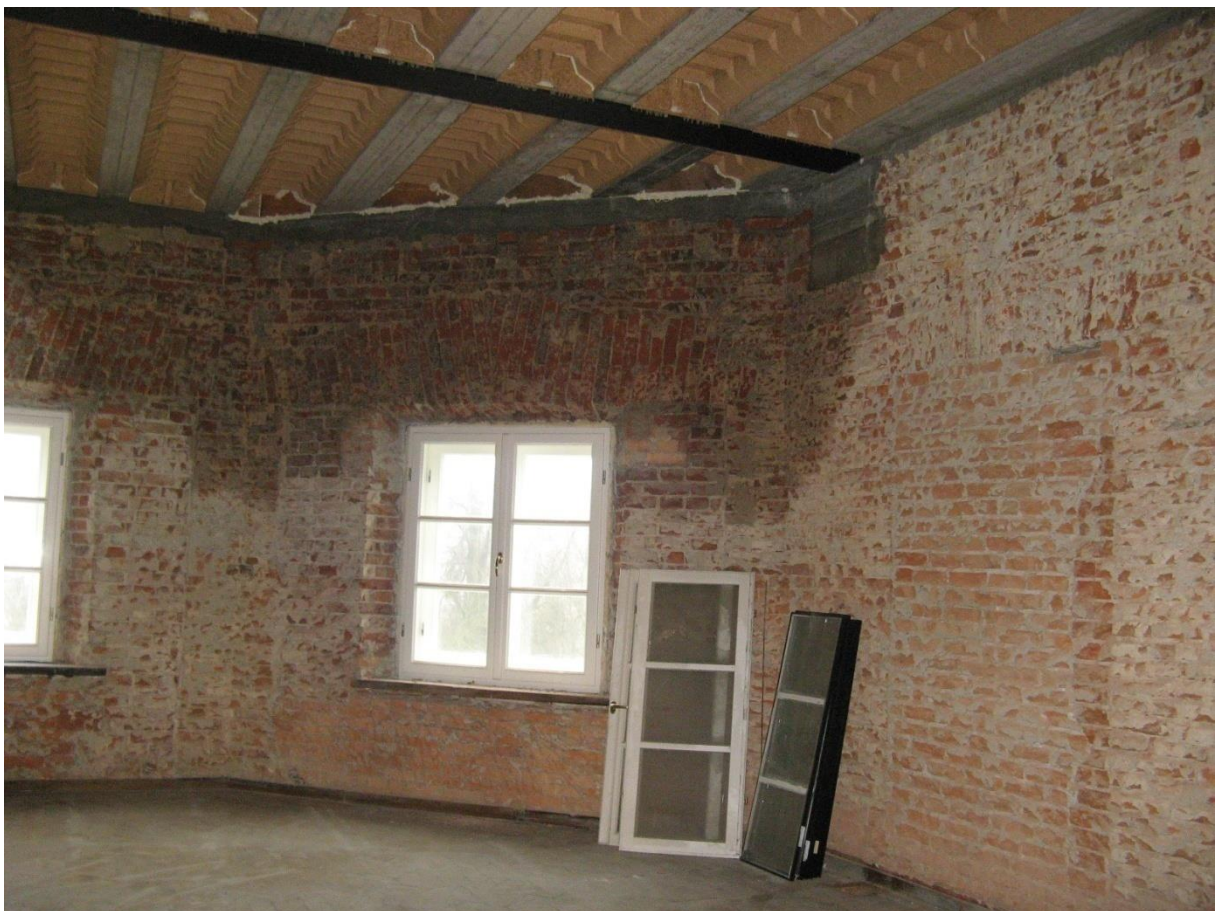
Brak tynków na ścianach w sali ośmiokątnej na piętrze
