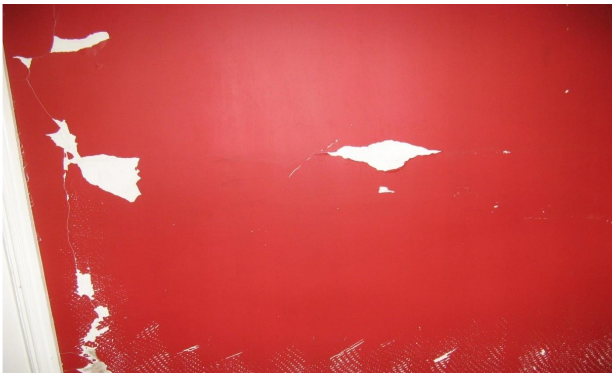
Odstająca farba na ścianach
