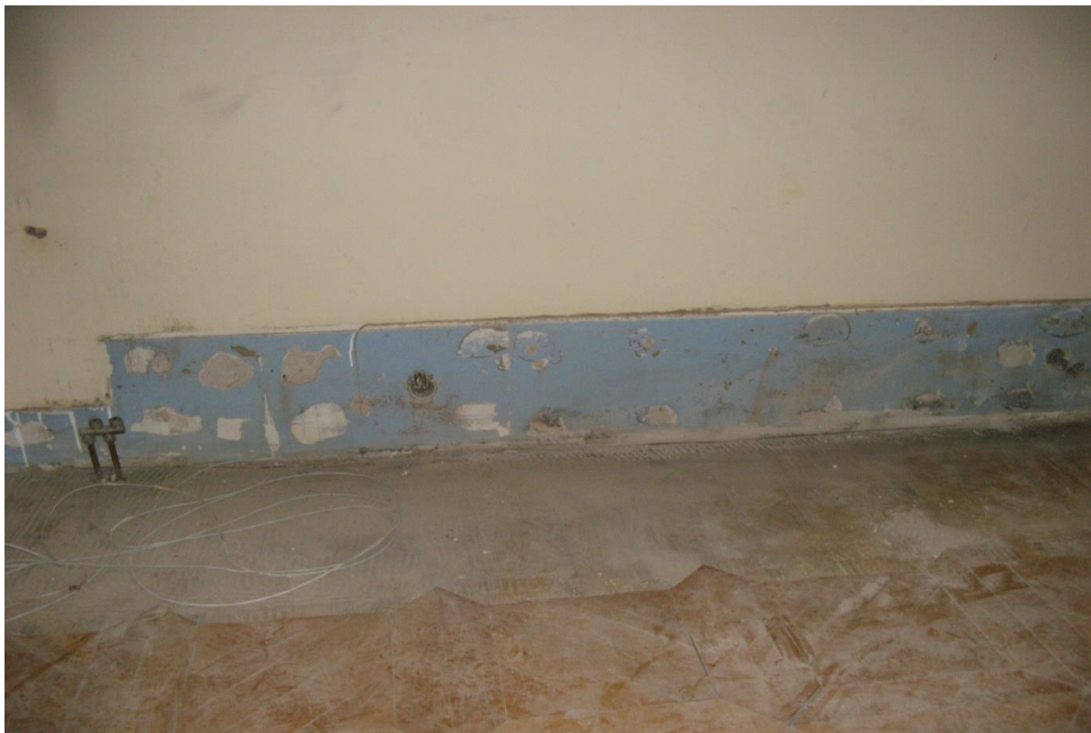
Uszkodzony tynk na ścianach
