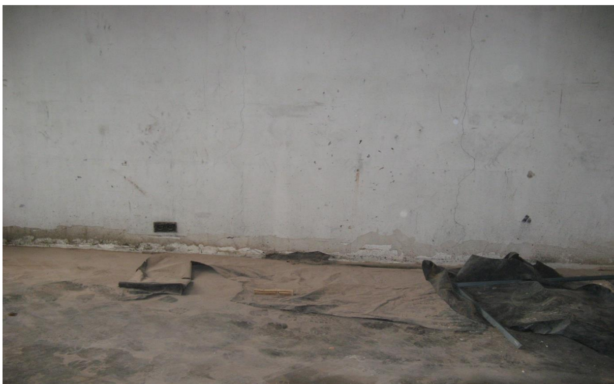
Popękane tynki na ścianach
