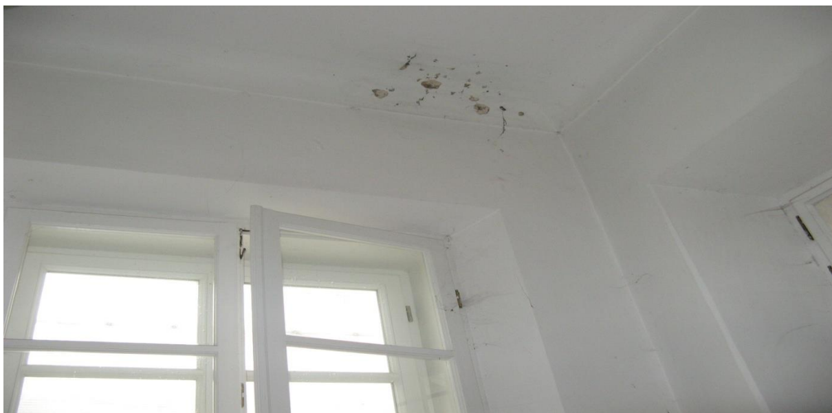
Uszkodzony tynk na suficie
