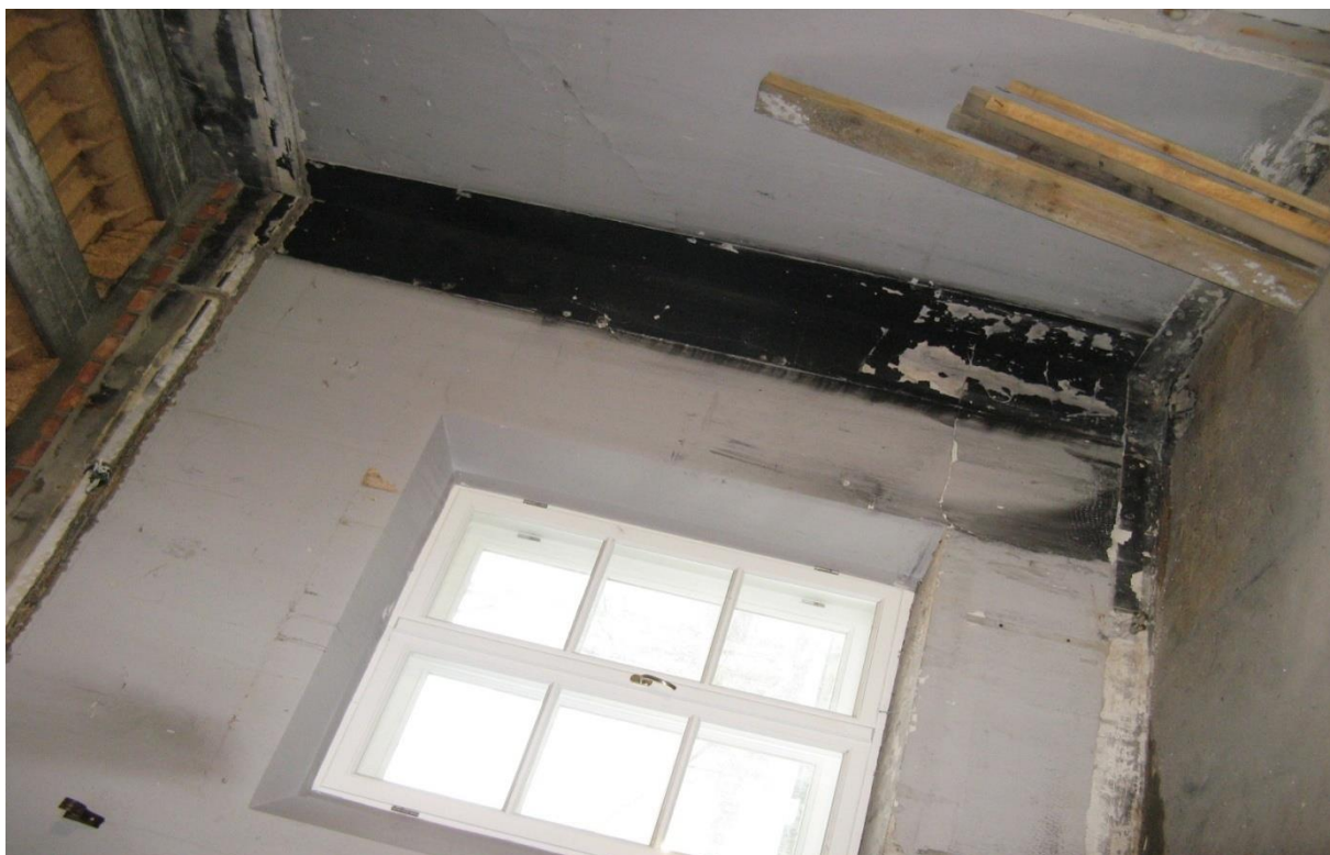
Uszkodzony tynk na ścianach
