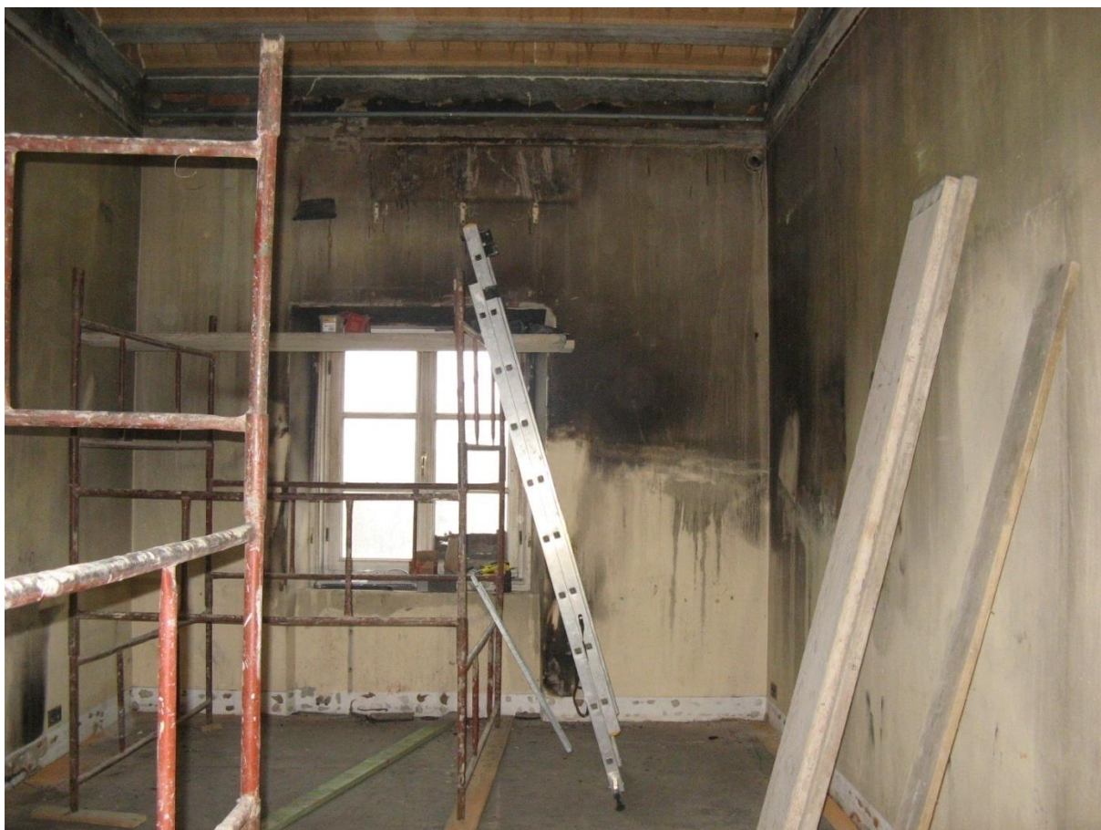
Uszkodzone tynki w wyniku pożaru
