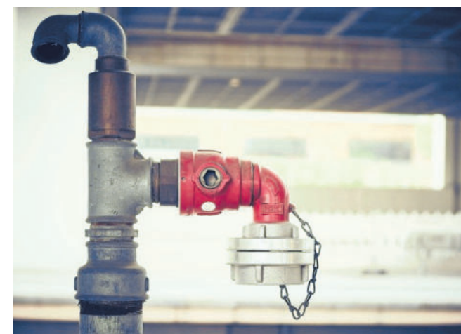
Zadbaj o zabezpieczenie instalacji wodociągowej przed mrozem
